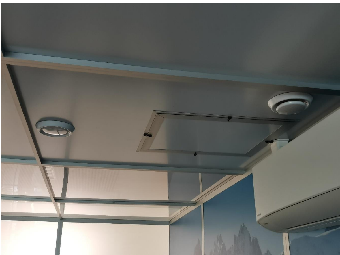
Obrázek 5. Ventily regulující přívod hypoxického vzduchu do komory
