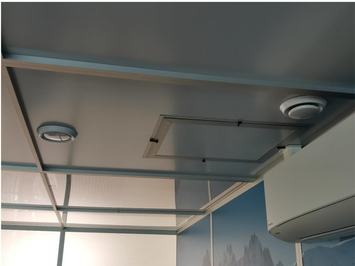
Obrázek 5. Ventily regulující přívod hypoxického vzduchu do komory
