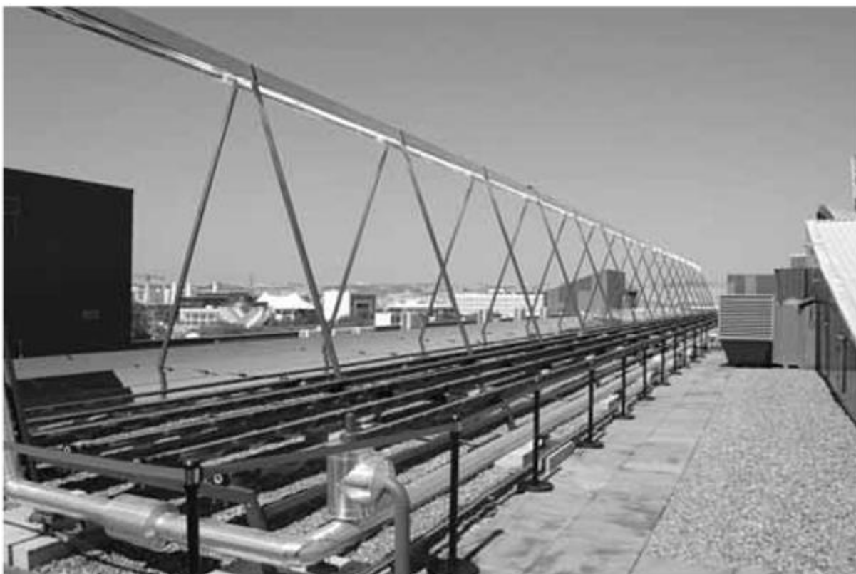
Obr. 3-4: Třetí průmyslový Solární projekt, z roku 2007 v Seville, Španělsko. Plocha zařízení je 352 m 2 , délka je 65 m, se stlačeným vodním oběhem o tlaku 16 barů a operační teplotě 180 °C. Použité zařízení bylo sluneční chlazení s dvojitým absorpčním chladičem (175 kW) [9] (s dovolením Industrial Solar GmbH).
