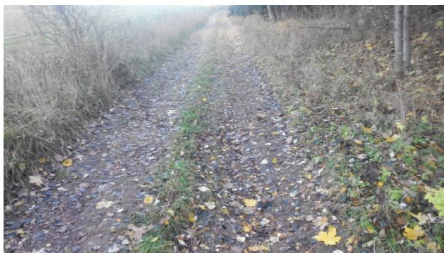
Obr. 8: Vytlačený a zarostlý střed vozovky – lesní cesta „K Bojišti“
