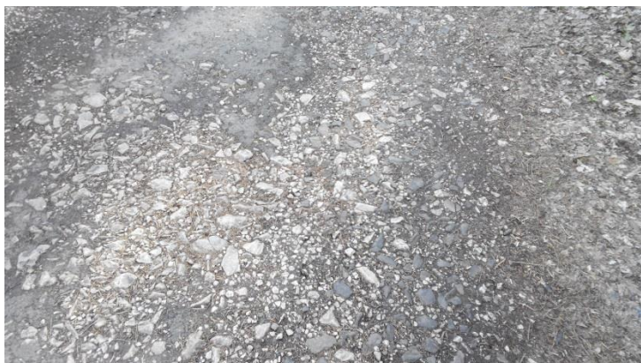
Obr. 9: Odtrhnutá o brusná vrstva - lesní cesta „Nad Kulturákem“
