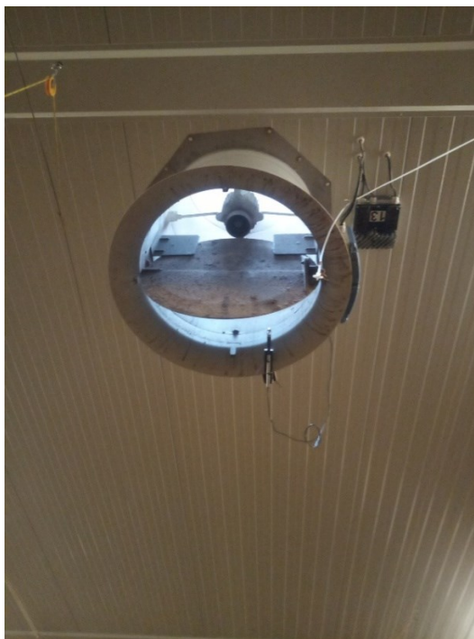
Obrázek 3.7: Stropní ventilátor s umístěnou sondou na vzduchu a měřičem průtoku Testo 435
