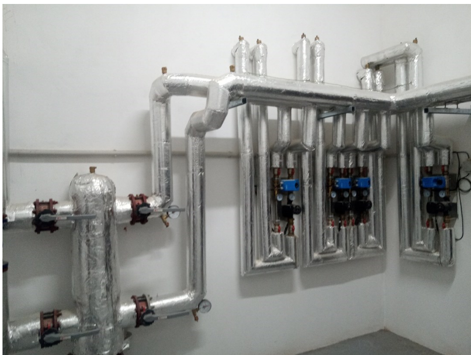
Obrázek 3.9: Rozvod vody na ohřev
