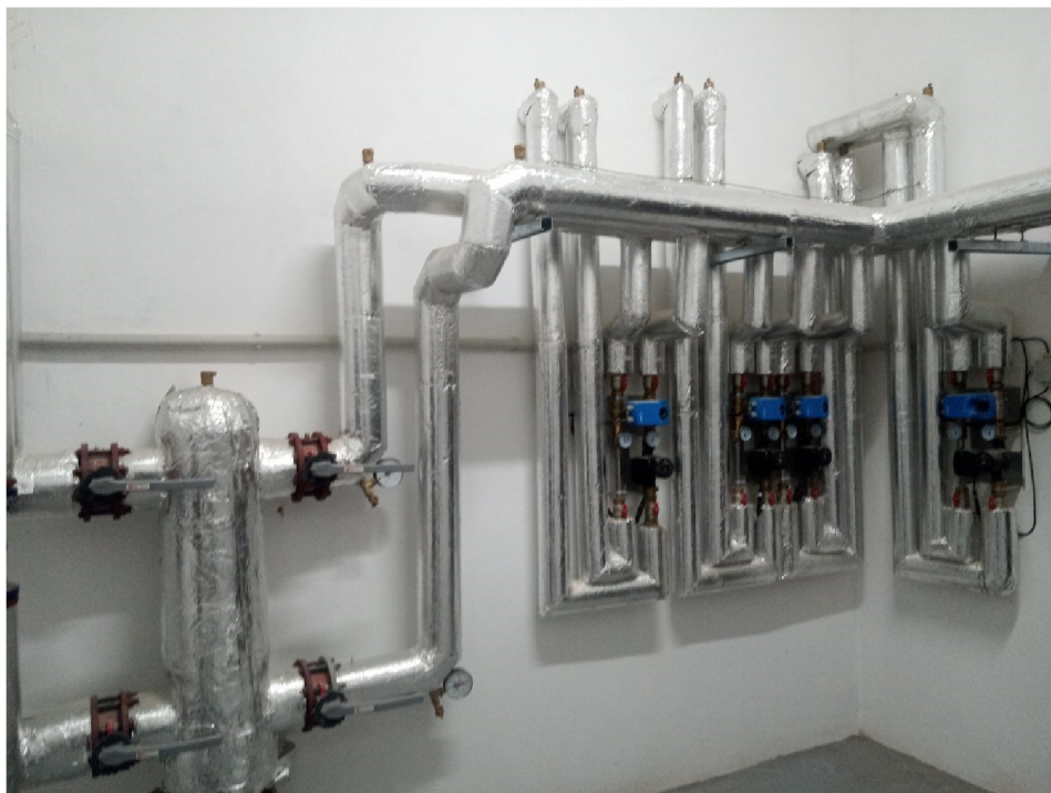
Obrázek 3.9: Rozvod vody na ohřev
