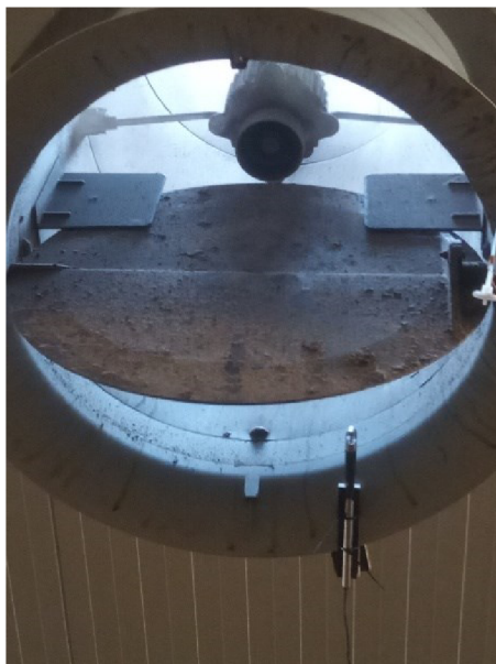
Obrázek 3.16: Ventilační otvor s upevněnou sondou
