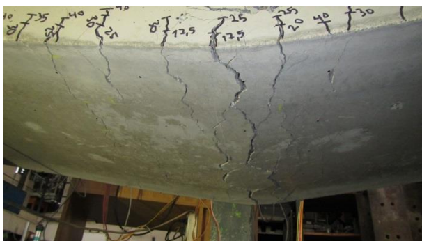
Obr. P5-28: Trhliny na tažené části betonu při dosažení meze únosnosti
