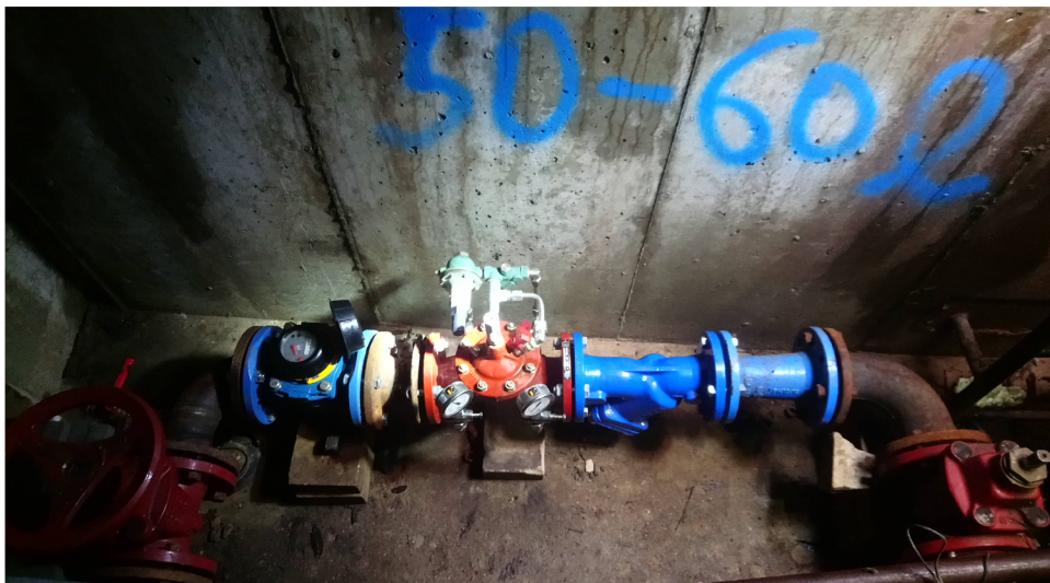
Obr. 10 Vodoměrná šachta spotřebiště Vsetín, TP 99 regulátor Sychrov DTP – indukční průtokoměr za redukčním ventilem, bez napojení na datalogger
