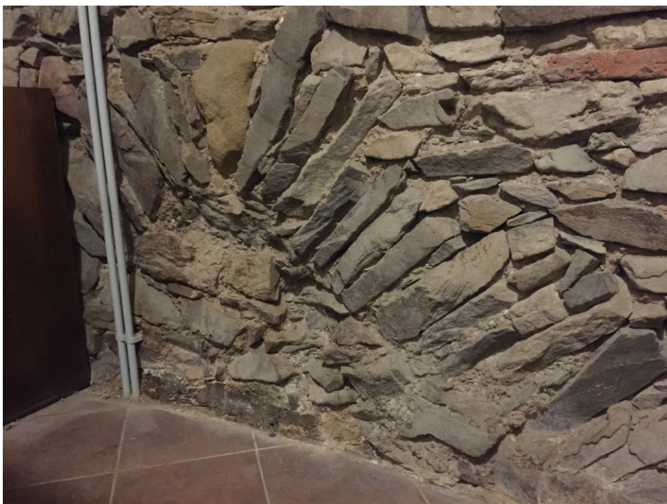
43. Mohelnice, městský dům 973/13, zazděný lomený portál v suterénu.
