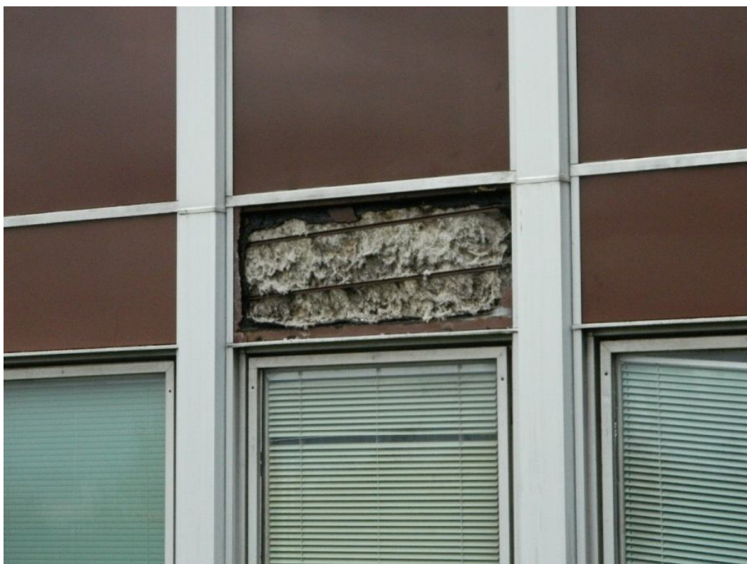
Obr. 1 Pohled na degradovanou tepelnou izolaci OD-001 „Boletický panel“
