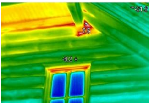
Obrázek 18 Výrazný tepelný most v ostění okna (časopis Dřevo&stavby , 2011)
