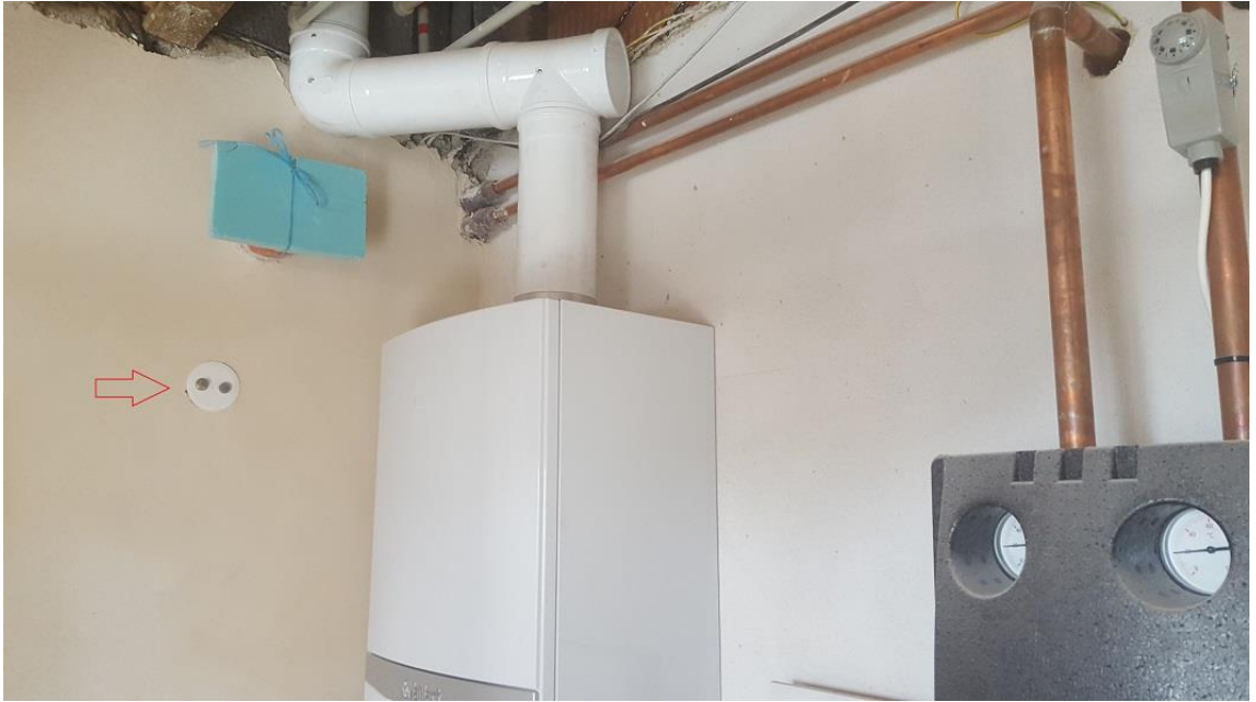
Obrázek B.3 Senzory pro detekci oxidu uhelnatého a zemního plynu umístěné u plynového kotle
