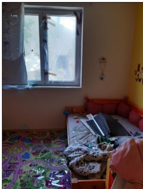
Obr. č. 26 - Zničené okenní tabule [vlastní]
