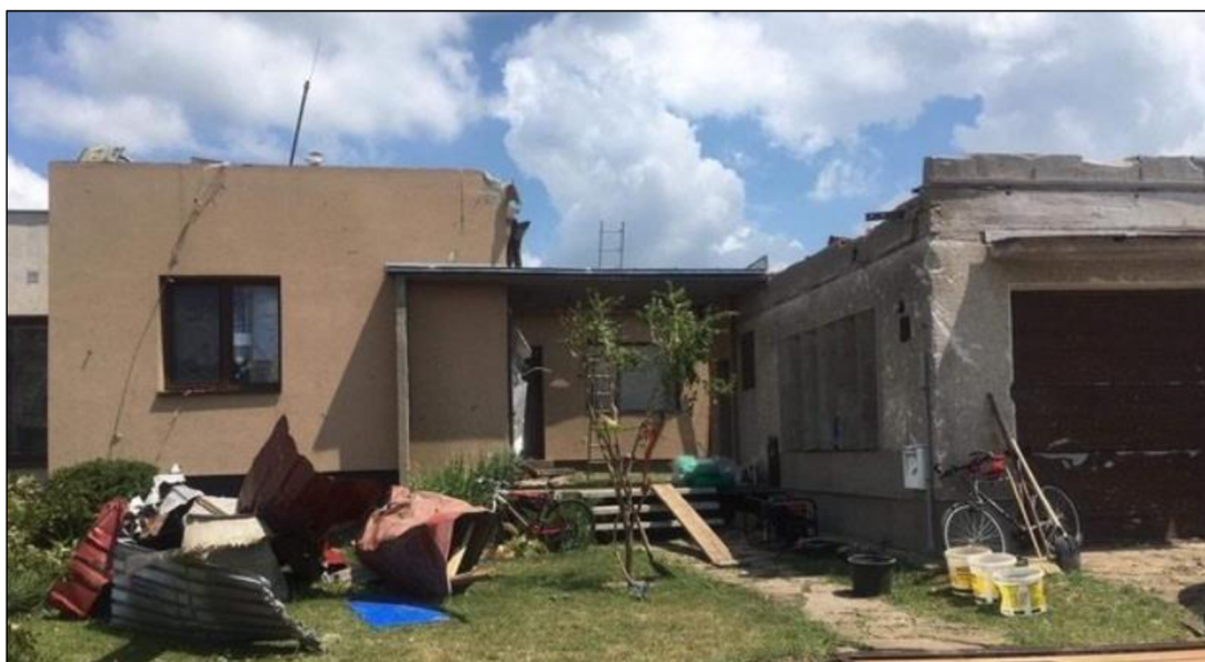
Obr. č. 20 - Poškozená fasáda rodinného domu a garáže [vlastní]
