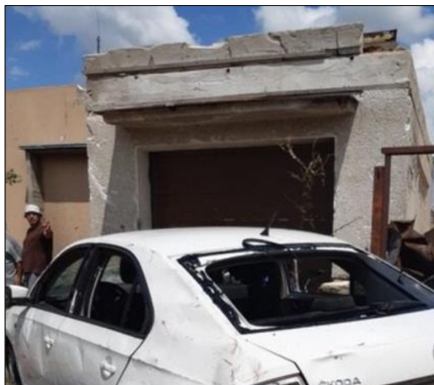
Obr. č. 18 - Poškození atik garáže [vlastní]
