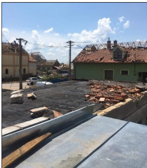
Obr. č. 17 - Poškozený střešní plášť garáže [vlastní]
