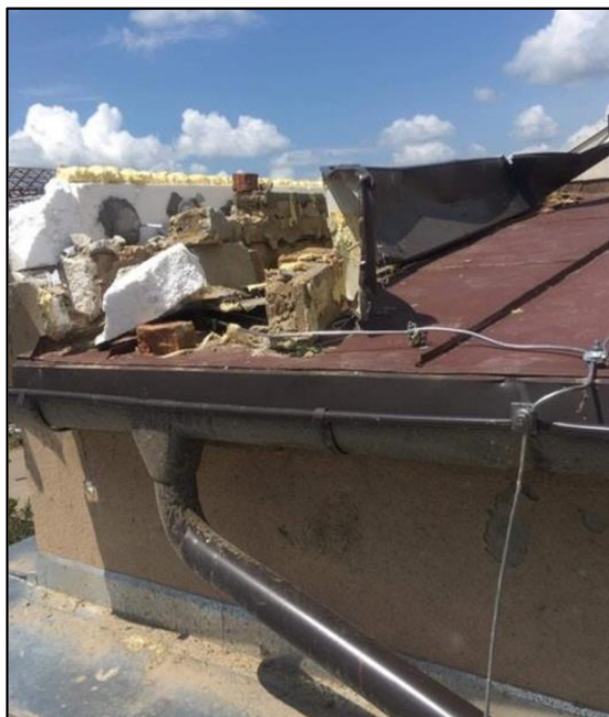
Obr. č. 15 - Poškození střešní krytiny a atiky rodinného domu [vlastní]
