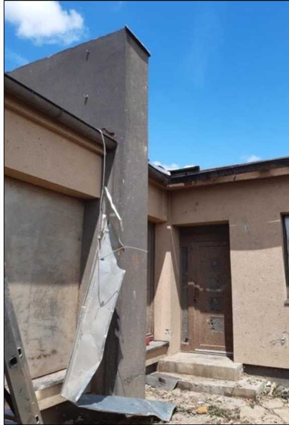
Obr. č. 21 - Vnější poškození komínu [vlastní]
