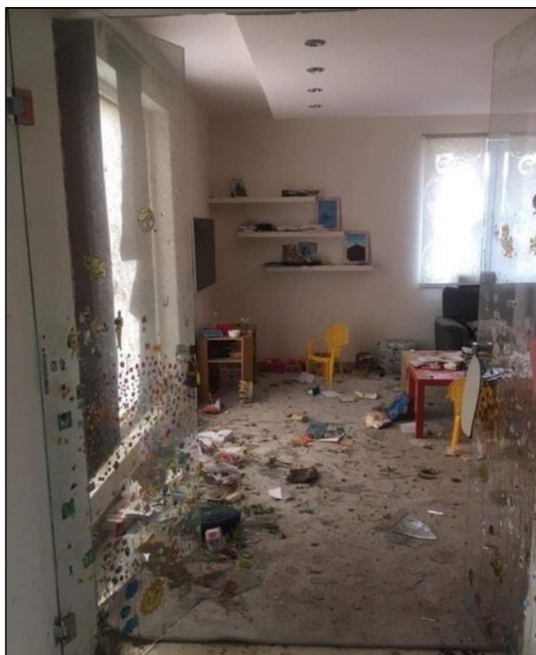
Obr. č. 25 - Zničené okenní tabule [vlastní]
