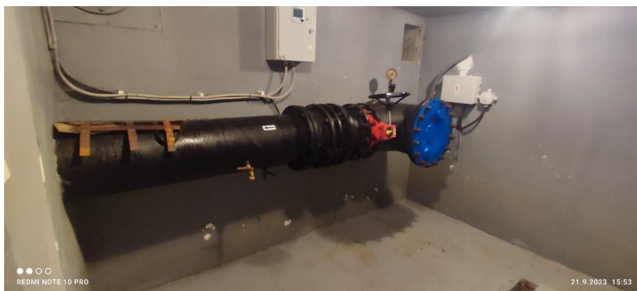
Obrázek 39: Vstup na ČDV, ID-055, odběrný kohout (Kurtík, 2023).
