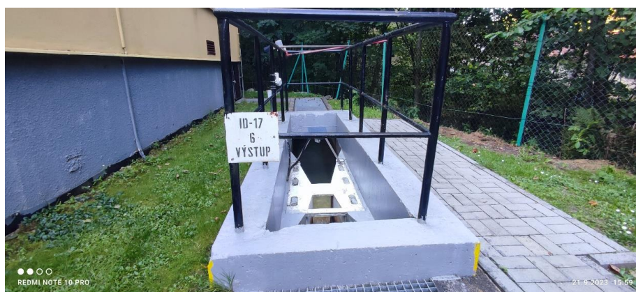
Obrázek 38: Výstup z ČDV, ID-017, Parshallův žlab (Kurtík, 2023).
