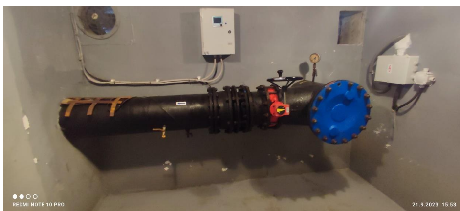
Obrázek 37: Vstup na ČDV, ID-055, odběrný kohout (Kurtík, 2023).
