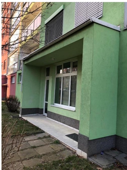
Obrázek 9: Stříšky sloužící ke sběru vody
