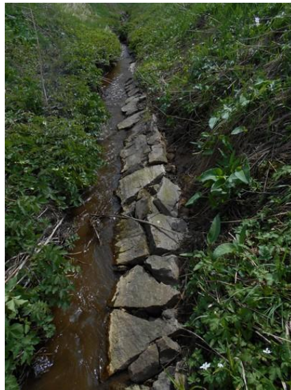
Foto 8.: stávající opevnění koryta
