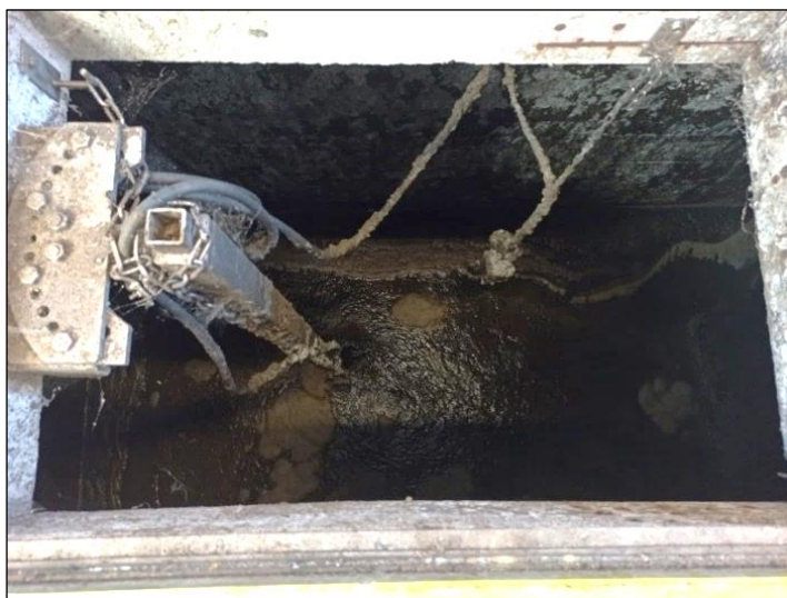
Obrázek 20: Uskladňovací nádrž na kal.
