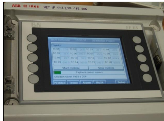
Obr. 33 Provozní jednotka PP65.
