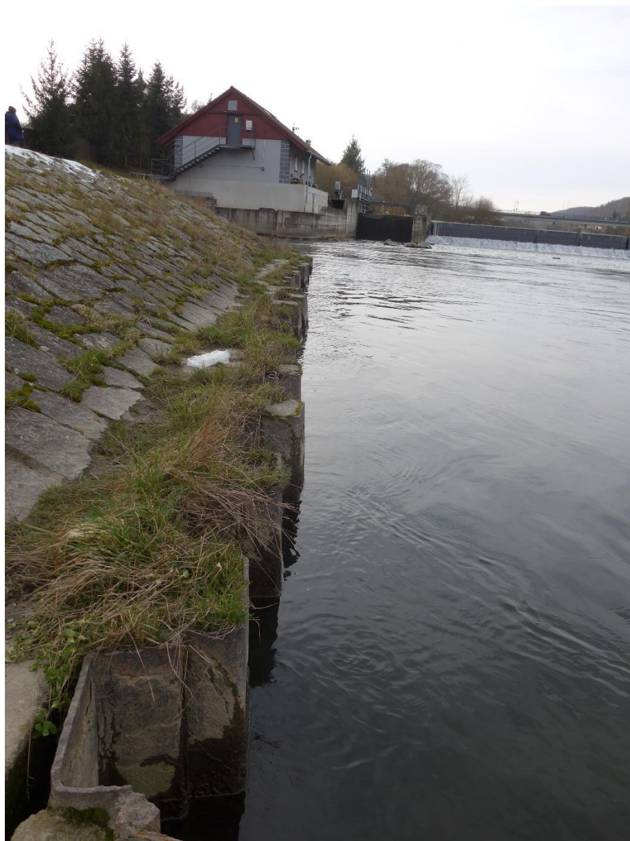
Obr.43: Zpevnění břehů v podjezí u jezu v Nižboru provedené z ocelových štětovic a kamenné rovnániny (Novotný L., 2023).
