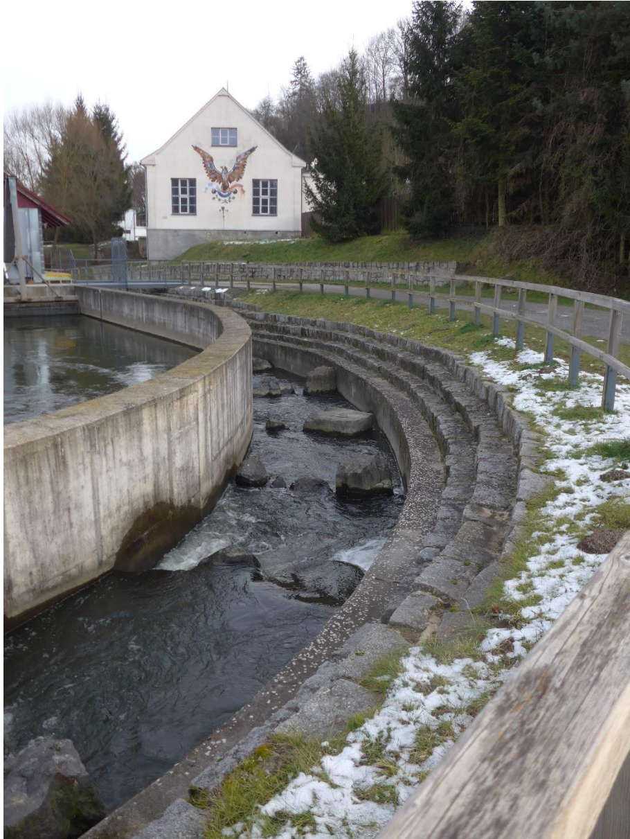
Obr.42: RP na jezu v Nižboru (Novotný L., 2023).
