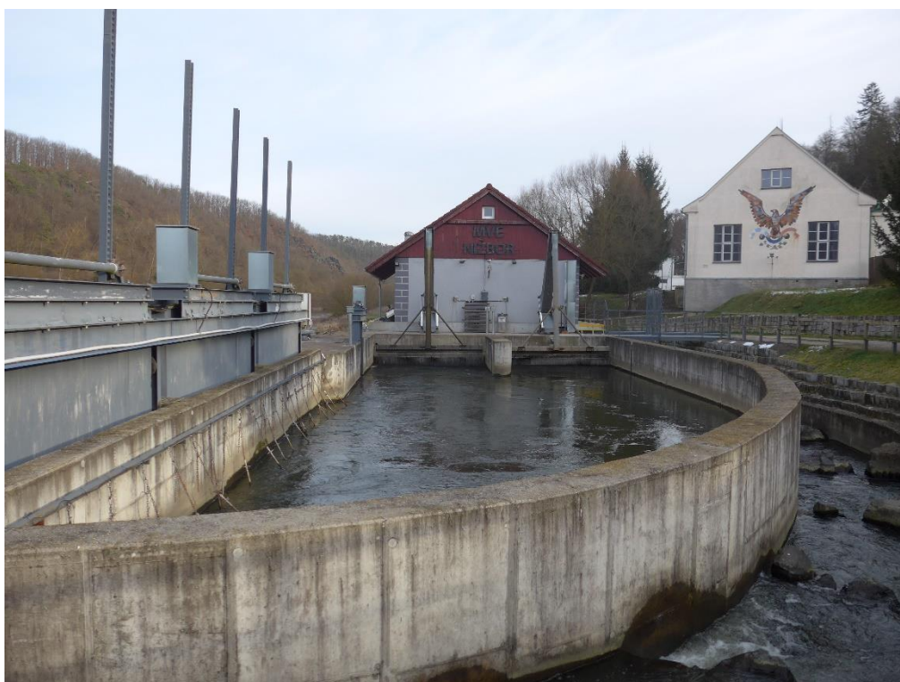
Obr.41: Vtok do strojovny MVE Nižbor s hydraulickými stroji na čištění jemných česlí (Novotný L., 2023).
