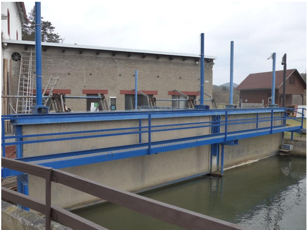
Obr.56: Vtok do strojovny MVE u Čechova mlýna na jezu v Čilé hrazený tabulovými uzávěry (Novotný L., 2023).
