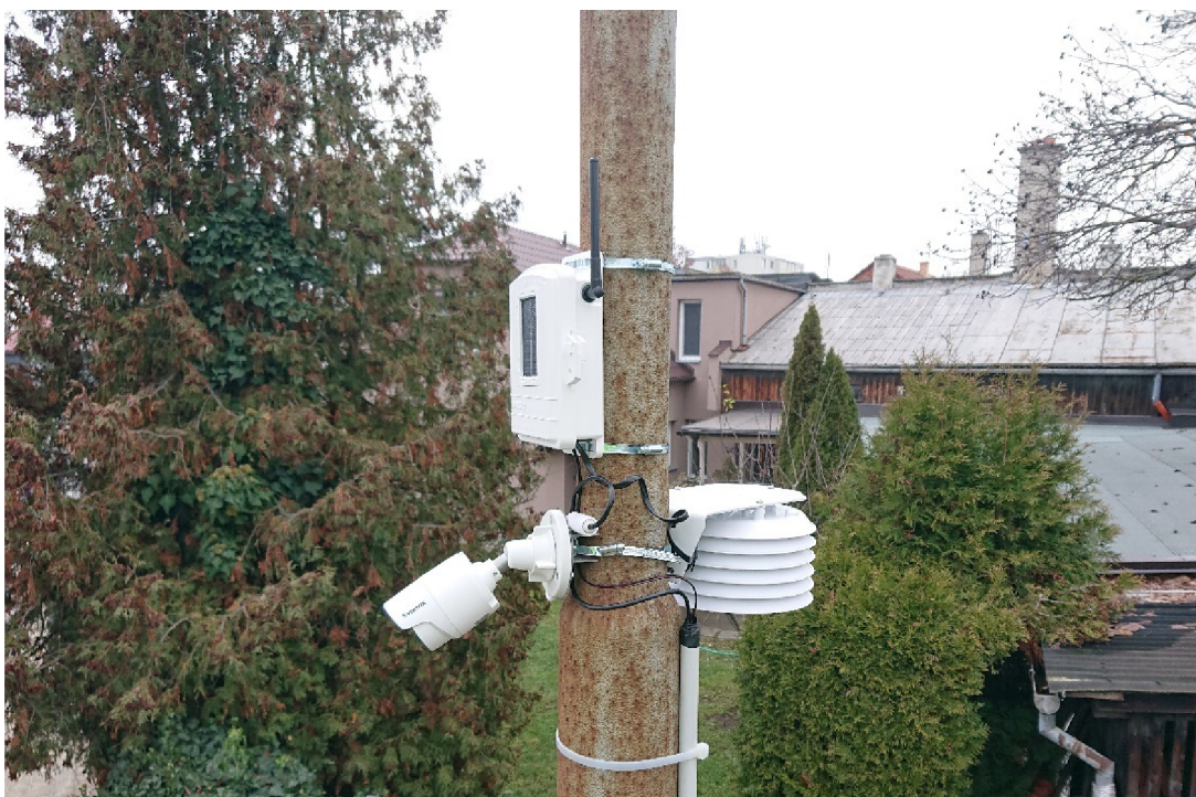
Obrázek 4: Sensor teploty vzduchu a vlhkosti s kamerou instalovaný na stožáru veřejného osvětlení. zdroj: vlastní fotografie
