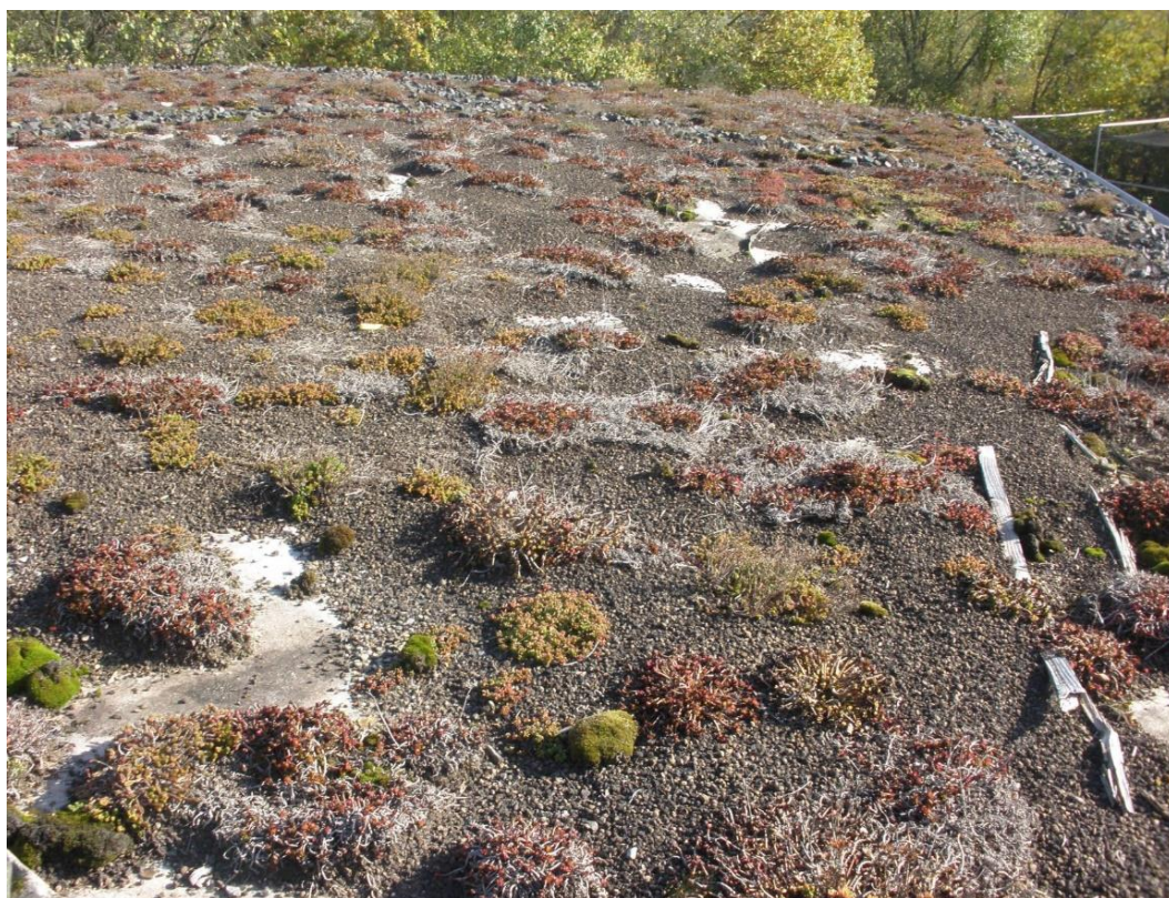
Obrázek 41: Nejvíce poškozená část zelené střechy, konec října 2019, Únětice
