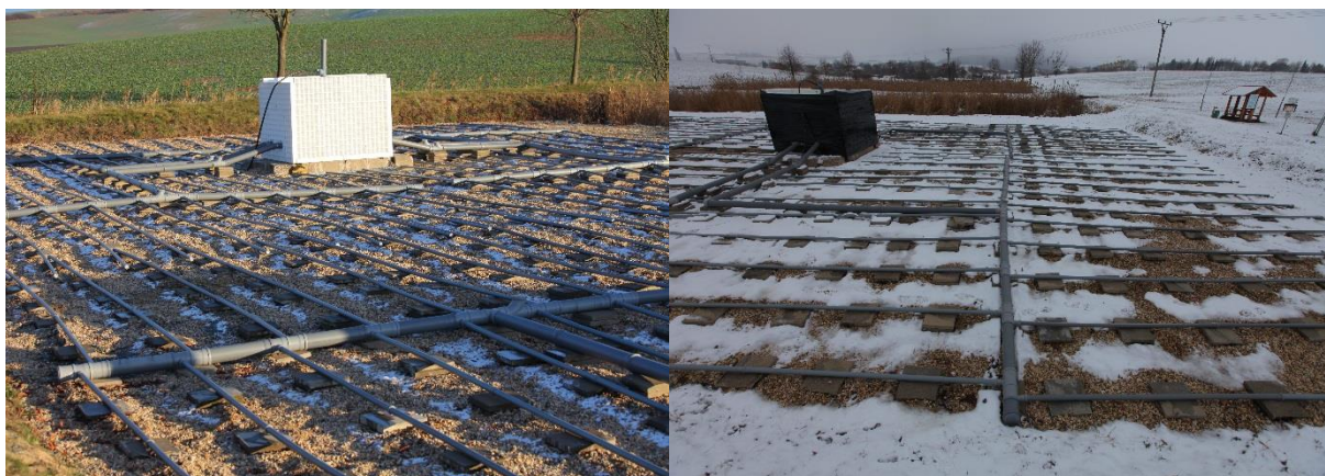
Obr. 36. Pohled před zateplením šachty (vlevo), pohled po zateplení šachty (vpravo), (archiv ÚVHK)
