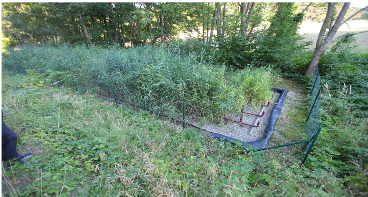
Obr. 8. Ukázka vertikálního filtru na kořenové čistírně ( Archív ÚVHK)
