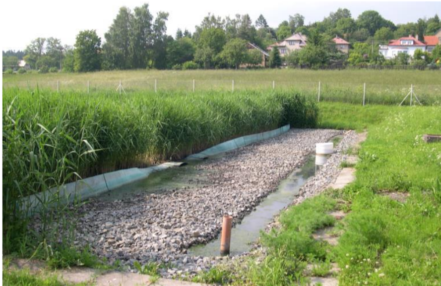
Obr. 5. KČOV Ondřejov byla uvedena do provozu v roce 1991 a je stále funkční (Vymazal, 2016).
