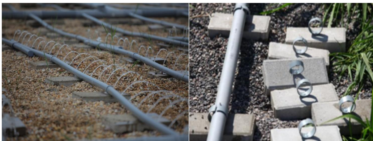
Obr. 23. Ukázka výtoku z penetrovaného rozdělovacího potrubí (vlevo), potrubí bude k těmto dlaždicím ukotvena pomocí „prstýnků“ (vpravo), (archiv ÚVHK)
