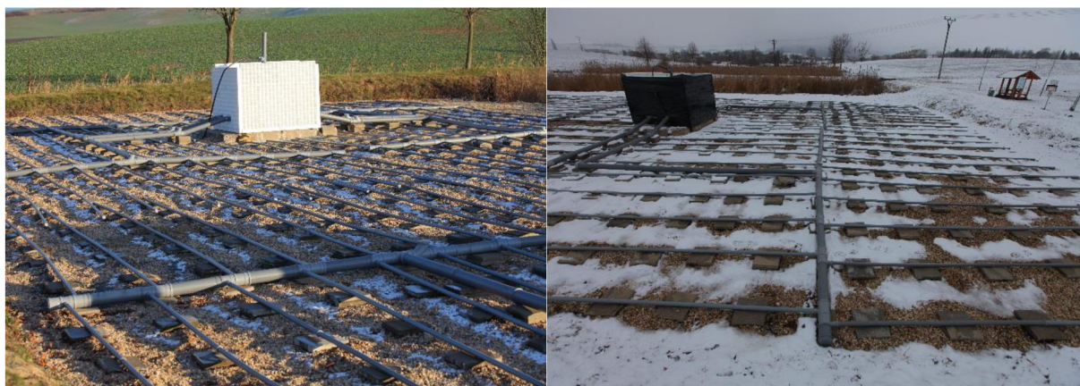
Obr. 36. Pohled před zateplením šachty (vlevo), pohled po zateplení šachty (vpravo), (archiv ÚVHK)
