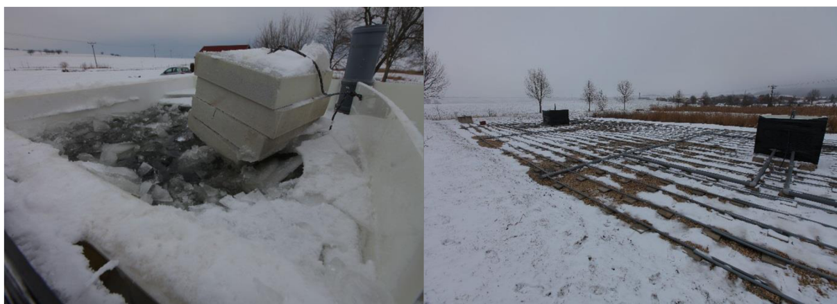
Obr. 35. Zamrznutí šachtové komory (vlevo), pohled na VF v zimním období (vpravo), (archiv ÚVHK)
