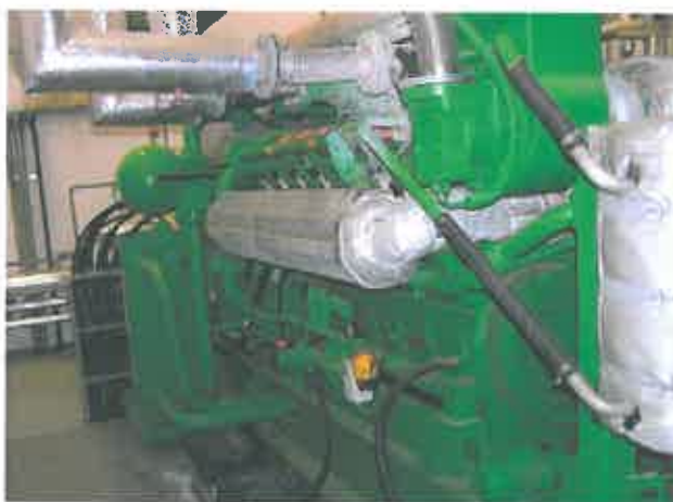
Obr. 3.5: Kogenerační jednotka [zdroj: autor]
