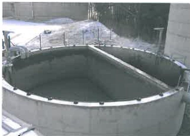
Obr. 3.4: Skladovací jímka digestátu [zdroj: autor]
