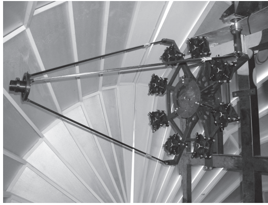
Obrázek 5.26: Fotografie již nainstalované mechanické konstrukce
