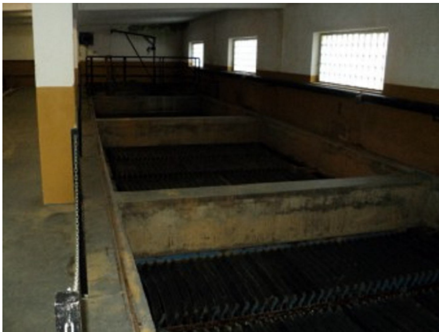
Příloha č. 6 Usazovací nádrže
