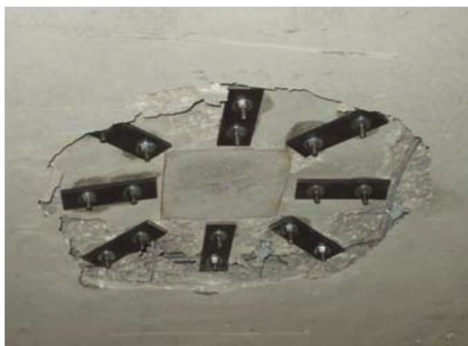
Obr. 2.26 Porušený vzorek po zesílení smykovými trny s ocelovou deskou kotvící dva trny [29]
