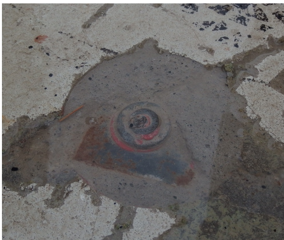
Obr. 5.74 Podložka 90/90/6 mm s dynamickým setem Hilti na horním povrchu desky s počínající korozí
