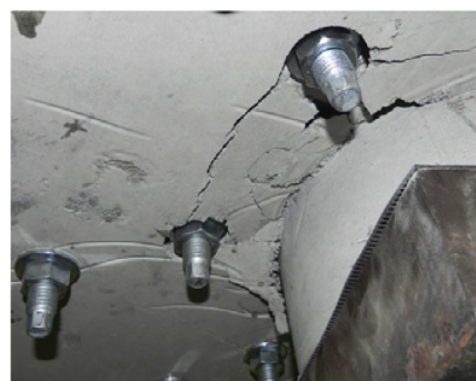
Obr. 2.32 Porušená konstrukce s aplikovanými šrouby do betonu [35]
