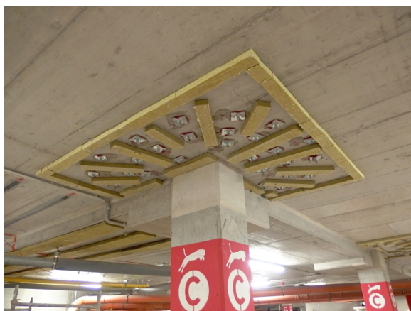
Obr. 2.47 Požární ochrana dodatečné smykové výztuže ve formě obkladu před finálním zaklopením spodní deskou (foto archiv autora)
