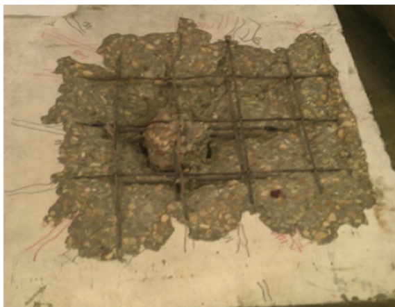
Obr. 2.35 Porušená konstrukce opravována předepnutými dodatečnými trny [39]
