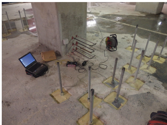
Obr. 6.15 Měření odporových tenzometrů přes ústřednu po finální injektáži sanace
