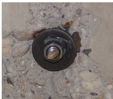
Obr. 5.66 Odprýsknutí betonu při spodním povrchu
