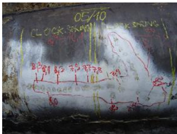
Obr.2.4 Označení tvaru defektu potrubí izolací s minimálními zbytkovými tloušťkami - výsledek ultrazvukového měření
