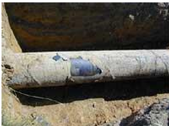
Obr. 2.3 Odkrytí potrubí s porušenou
