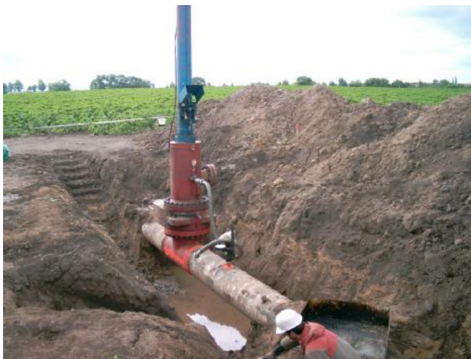
Obr. 2.5 Instalace „stopplovacího“ zařízení ( v pozadí obrázku )v blízkosti prováděné opravy výřezem z potrubí
