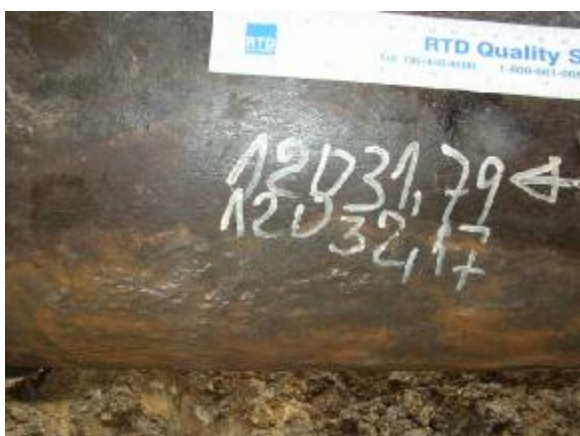
Obr. 1.4 Korozní napadení potrubí
