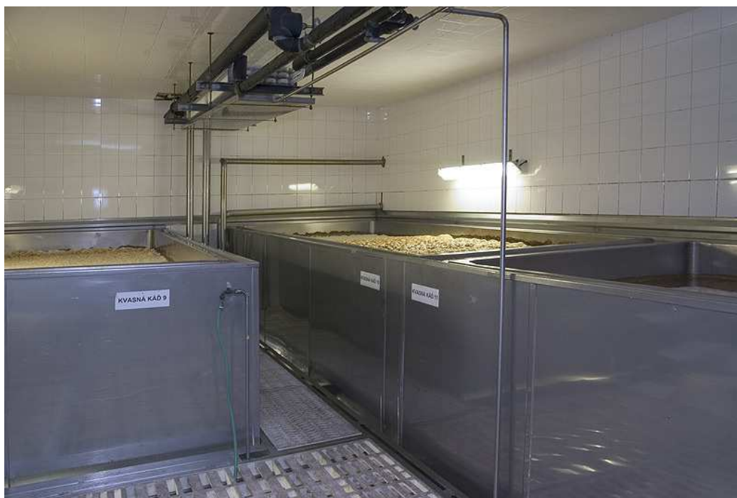
Kvasné kádě (spilky) pivovaru po rekonstrukci
