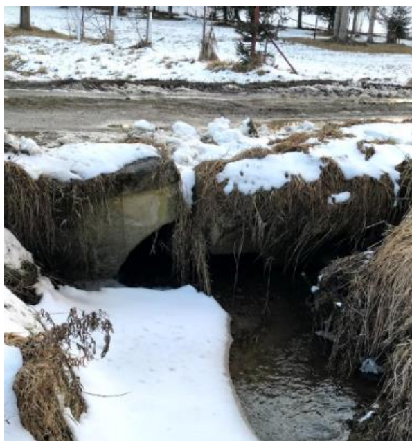
Obr. 35 KP5: Poškodený priepust [zdroj: vlastný]
