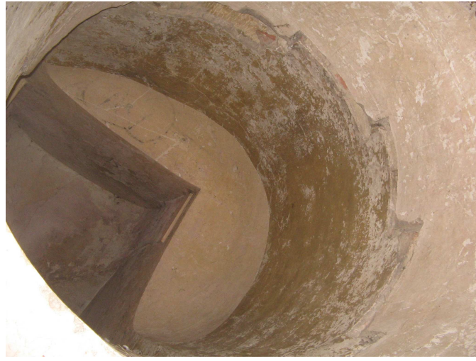
115. Pozůstatek po šnekovém schodišti, Ostré, Kalvárie, kaple Povýšení sv. Kříže.
