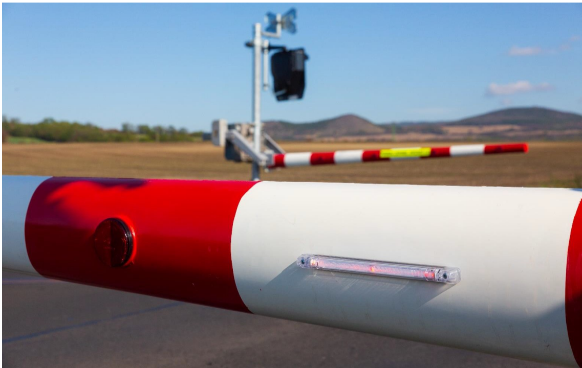
Obr. 3.3 Osvětlená břevna závor na železničním přejezdu
