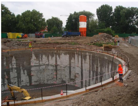
Obrázek 6 Retenční nádrž Jeneweinova, Brno [37]
