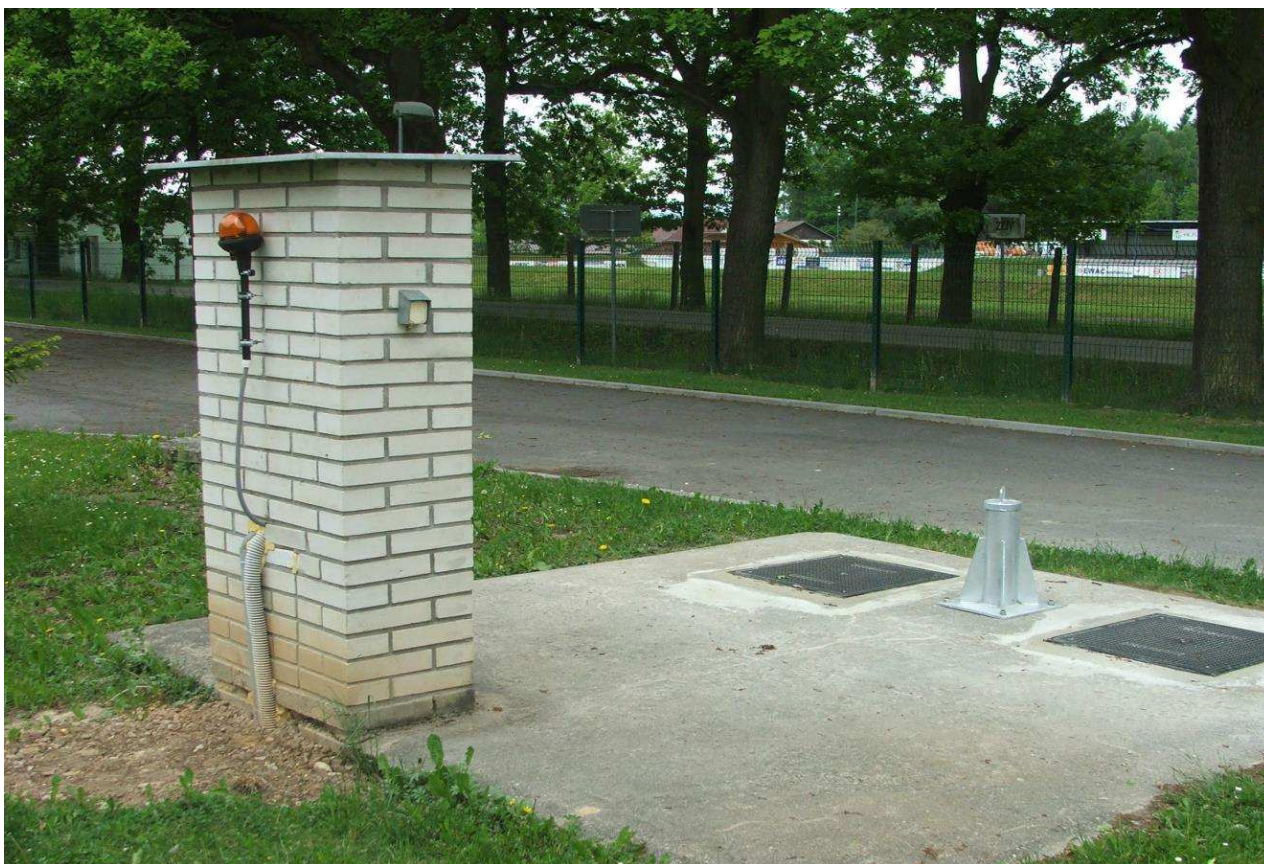
Příloha č. 18: Přečerpávací stanice zneškodněných odpadních vod do městské kanalizace Zliv (zdroj: zpracovatel)
