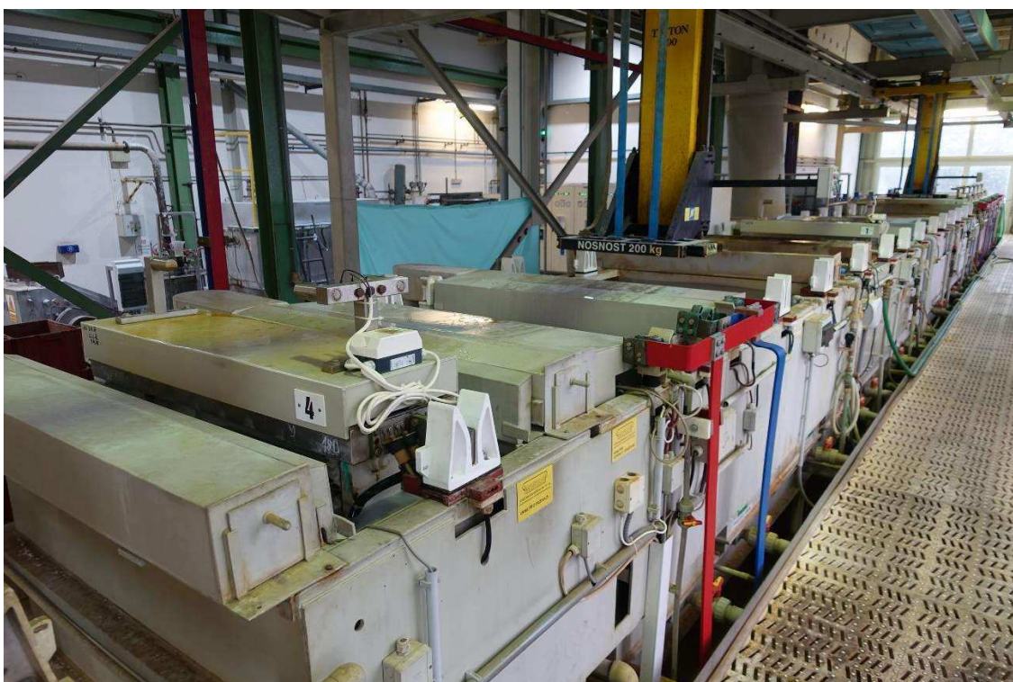
Příloha č. 2: Galvanická niklovací linka v provozovně PRYM CONSUMER CZ s.r.o. (zdroj: zpracovatel)
