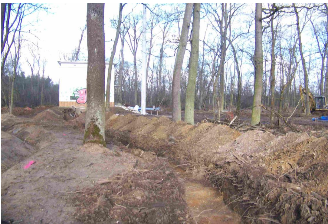
Obrázek 10: Pohled na okolí čerpací stanice, kde v současné době probíhají zemní práce související s rekonstrukcí výtlačného řadu a přílehlého systému povrchového odvodnění realizovaného v areálu vodního zdroje (zdroj: vlastní)
