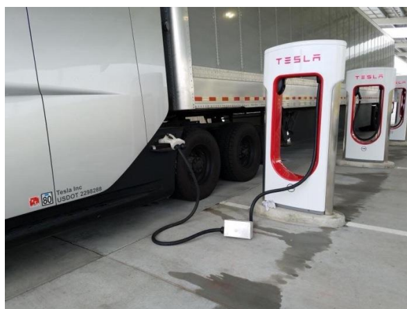
Obr. 29 Stanice Tesla Megacharger [68]
