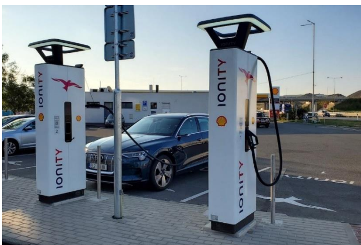
Obr. 37 Ionity dobíjecí stanice (odpočívka Nupaky, ČR) [94]
