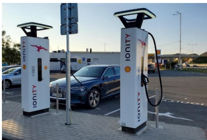
Obr. 37 Ionity dobíjecí stanice (odpočívka Nupaky, ČR) [94]
