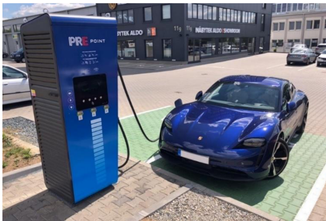
Obr. 35 Dobíjecí stanice značky Hypercharger, provozována PRE (Brno, ČR) [85]
