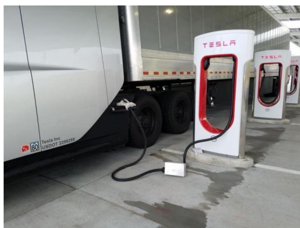
Obr. 29 Stanice Tesla Megacharger [68]
