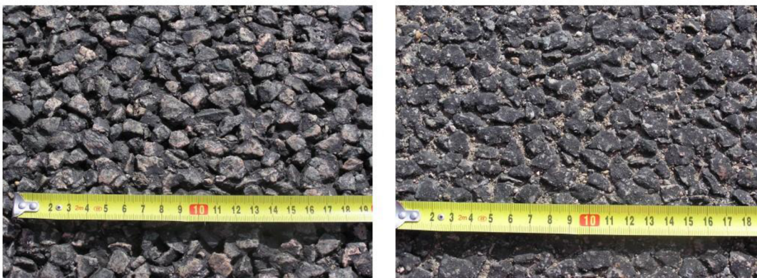
Obrázek 2: Detail drenážního koberce v řádném stavu (vlevo) a detail zaneseného drenážního koberce (vpravo) (6)
