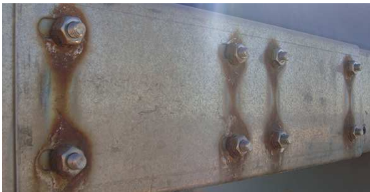
Obr. 7: Koroze austenitické oceli [10]
