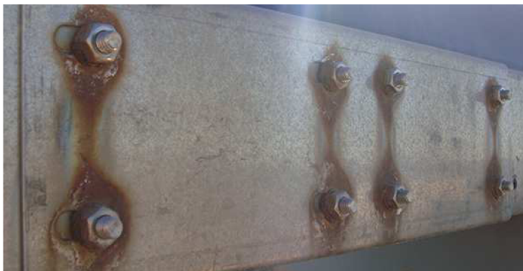
Obr. 7: Koroze austenitické oceli [10]
