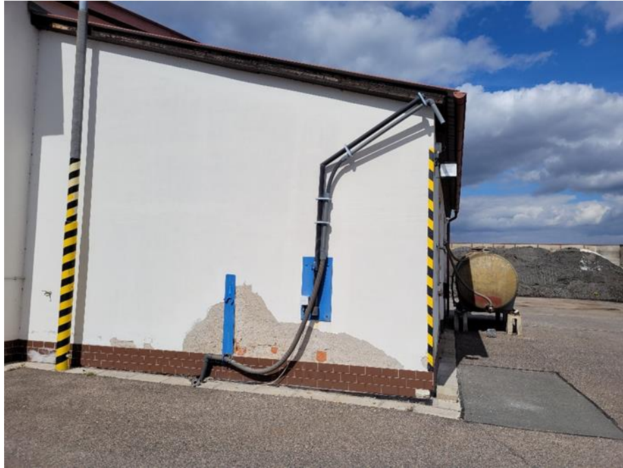
Obr. 4.13 Dopravní zařízení solanky do vozidel
