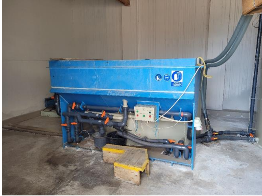
Obr. 4.12 Míchací zařízení na výrobu solanky
