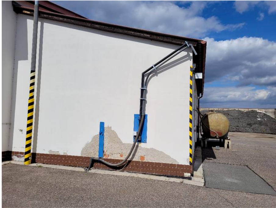
Obr. 4.13 Dopravní zařízení solanky do vozidel
