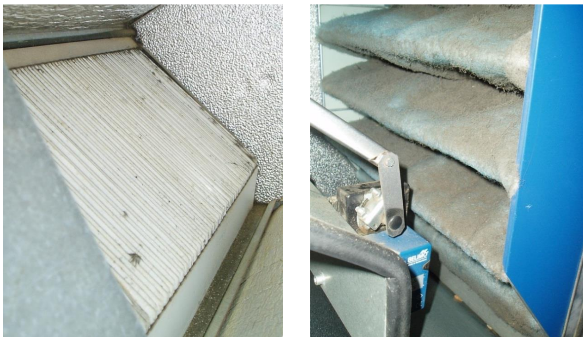
Obr. 8.18: Znečištěné lamely deskového rekuperačního výměníku pro ZTT (vlevo) a zanesený filtr cirkulačního vzduchu v teplotně vzdušné VZT jednotce (vpravo) – foto: autor
