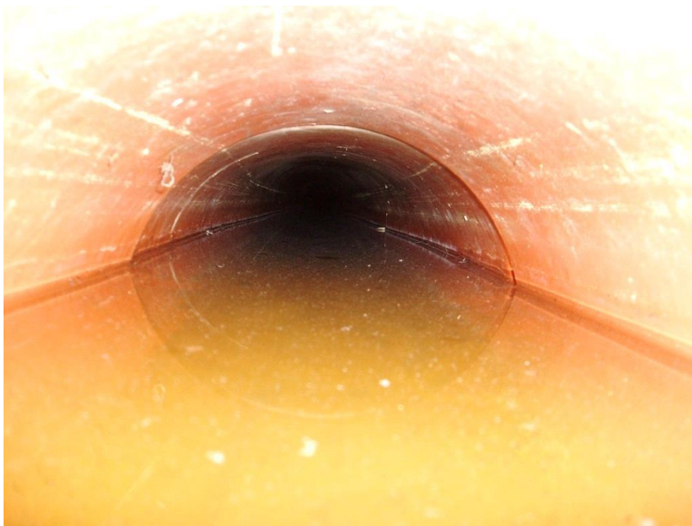
Obr. 8.25: Srážková voda zatečená v ZVT č. 3 – náhled do potrubí (foto: autor)
