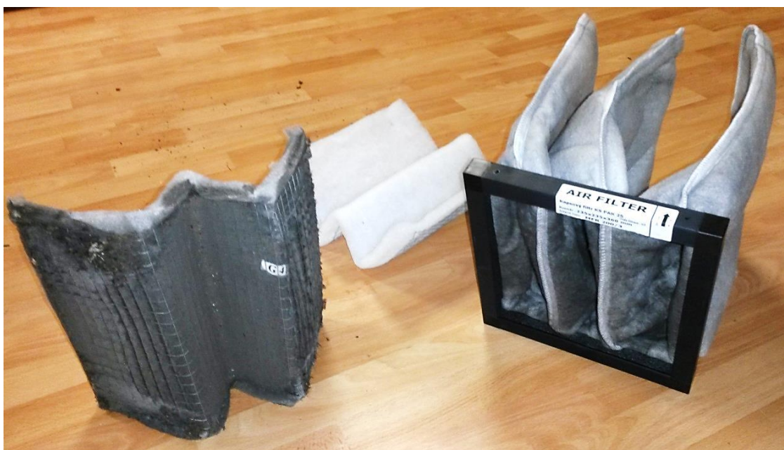
Obr. 8.11: Zanesený filtr na sání (vlevo) a výstupu (vpravo) po ročním provozu experimentálního zemního výměníku FSI VUT – foto: autor, 2015-01-14
