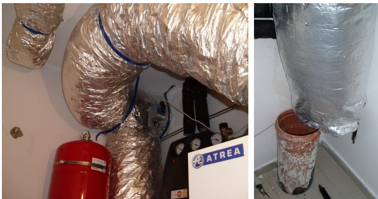
Obr. 8.21: Vnitřní VZT rozvod z hliníkového „Flexo“ potrubí pro napojení sání vzduchu z fasády (vlevo) a zemního výměníku tepla (vpravo) do větrací jednotky, ZVT č. 6 – foto: autor
