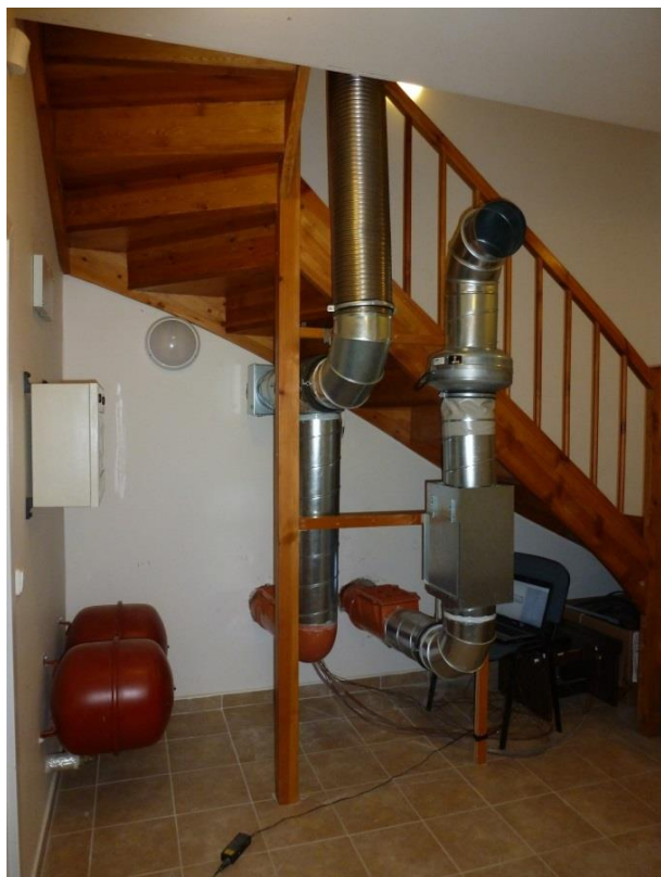
Obr. 6.16: Vstup a výstup do/ze zemního výměníku a jednoduchý VZT rozvod v přízemí (foto: autor)
