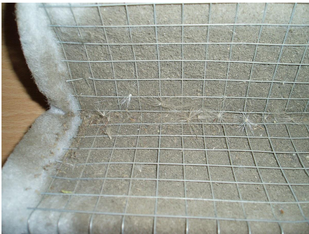
Obr. 8.9: Detail zaneseného filtru na sání experimentálního výměníku FSI VUT – přední strana (foto: autor, 2013-05-29)
