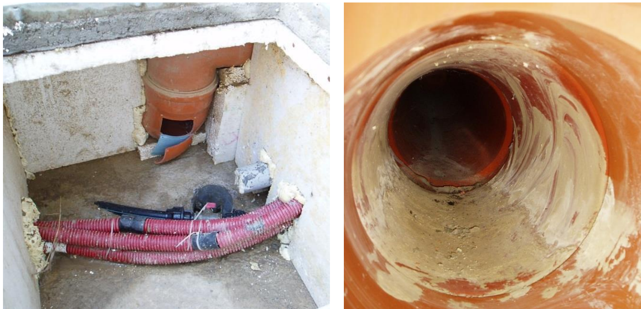
Obr. 8.23: Inspekční otvor v potrubí ZVT č. 7 (vlevo) a fotografie vnitřku potrubí (vpravo) – foto: autor
