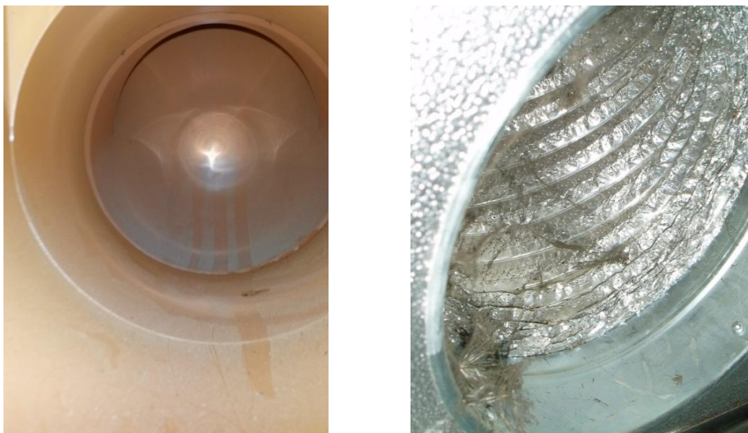
Obr. 8.19: Zachycený prach v místě změny směru proudění vzduchu (vlevo) a znečištění zachycené na povrchu hliníkového „Flexo“ potrubí (vpravo) – foto: autor
