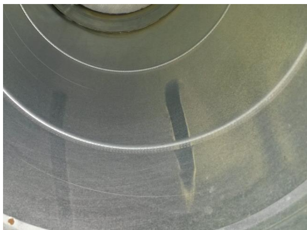
Obr. 8.14: Zanesené „Spiro“ potrubí na vstupu do exp. zemního výměníku tepla (č. 1) – foto: autor
