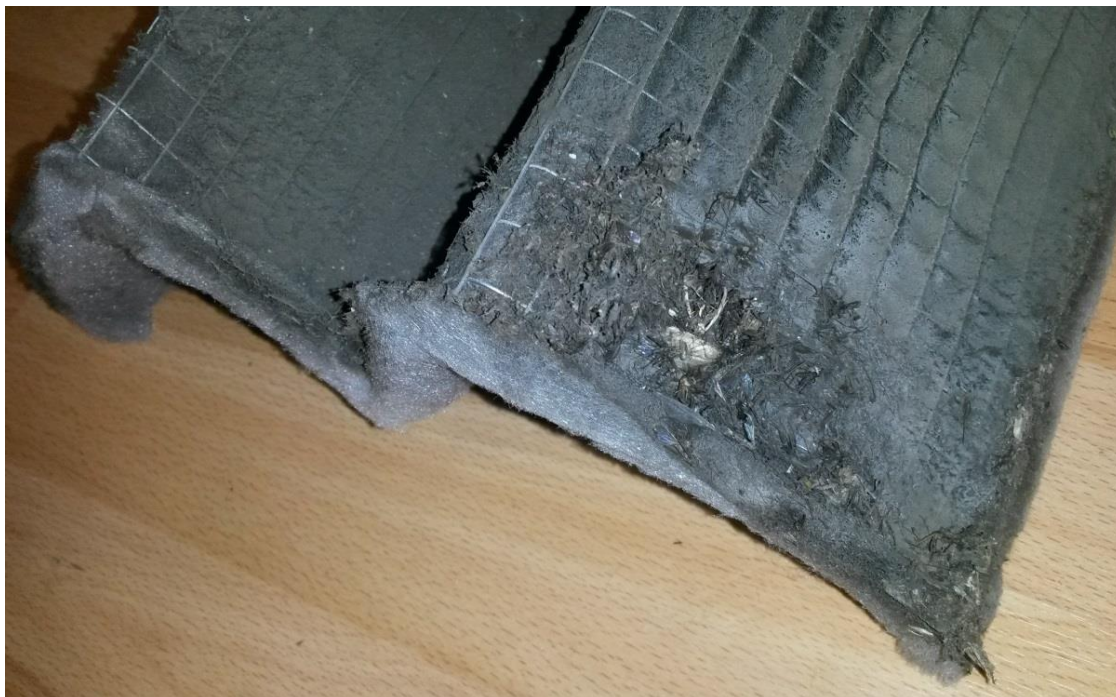
Obr. 8.10: Detail zaneseného filtru na sání experimentálního zemního výměníku FSI VUT po dalším roce provozu – přední strana (foto: autor, 2015-01-14)
