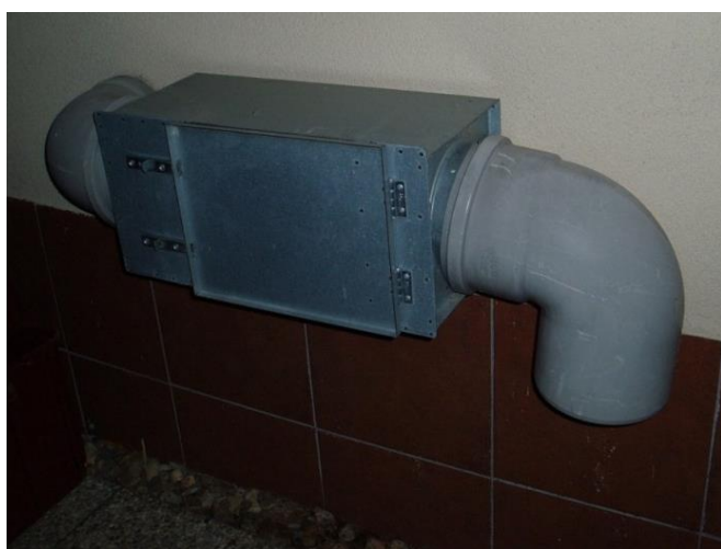
Obr. 8.5: Nasávání vzduchu do ZVT přes filtrační box s výměnným filtrem – ZVT č. 8 (foto: autor)
