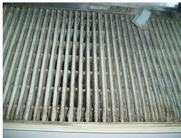
Obr. 4.3: Znečištěné lamely deskového rekuperačního výměníku pro ZVT (foto: autor)
