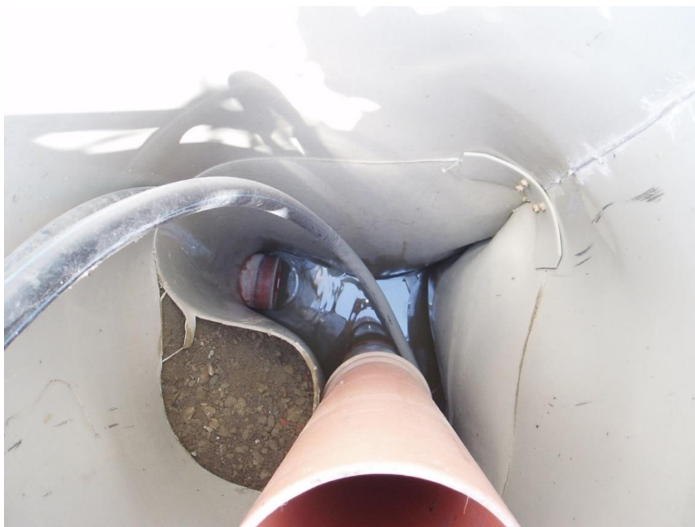
Obr. 8.4: Defekt plastové nasávací šachty – ZVT č. 16 a 17 (foto: autor)
