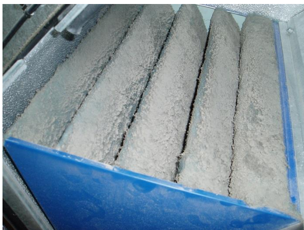
Obr. 4.2: Zanesený filtr cirkulačního vzduchu v teplovzdušné VZT jednotce (foto: autor)
