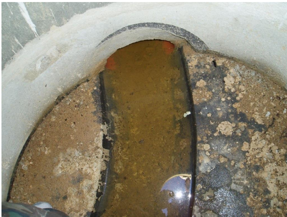
Obr. 8.26: Srážková voda zatečená v ZVT č. 3 – zatopené dno kontrolní šachty (foto: autor)
