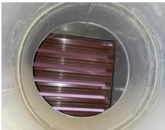
Obr. 8.13: Znečištěné VZT potrubí v těsné blízkosti za fasádní protidešťovou žaluzií – foto: autor
