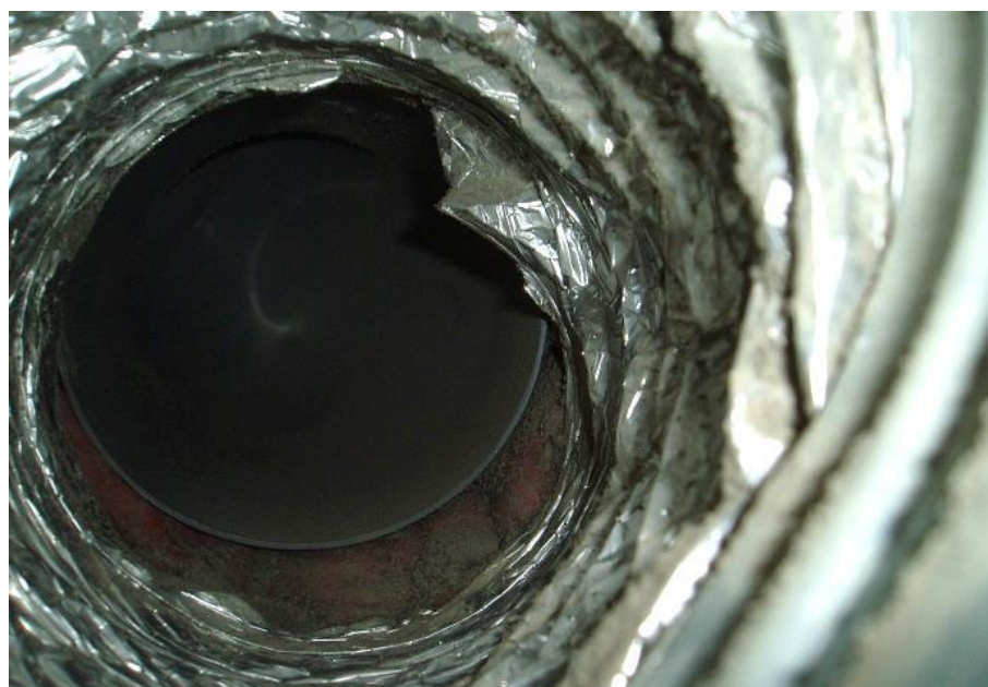
Obr. 8.20: Nečistoty zachycené na povrchu hliníkového „Flexo“ potrubí a v místě jeho napojení na plastové potrubí – (foto: autor)
