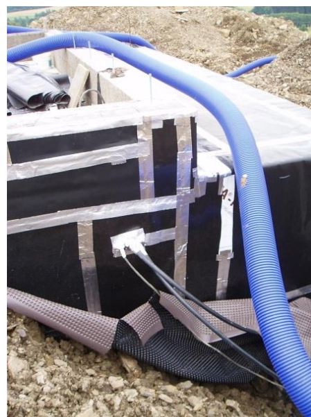
Obr. 3.1b: Potrubí ED Geoflex 200 pro přímý typ ZVT (foto: autor)
