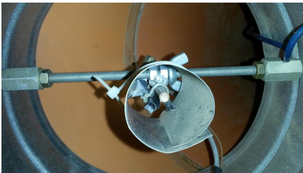
Obr. 6.20: Teplotně-vlhkostní čidlo „TRH5“ na vstupu do ZVT (foto: autor)
