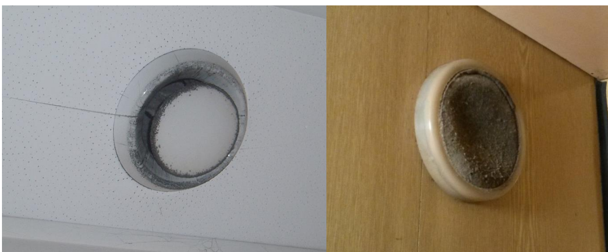
Obr. 8.28: Zašpiněná vyústka pro odtah vzduchu v nákupním centru v Brně (vlevo) a zanesený odtah ze sociálního zařízení panelového domu ve Vyškově – foto: autor
