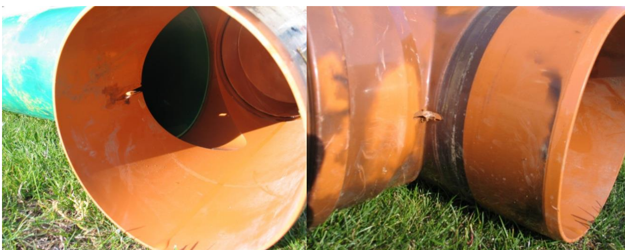
Obr. 8.27: Defekt potrubí ZVT č. 15 vlivem jeho čištění – foto: Petr Halásek
