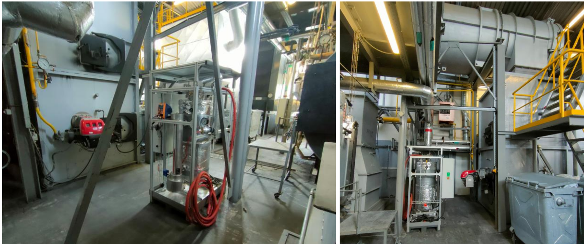
Obrázek 46 – HGA ve spalovně nemocničních odpadů během experimentu.
