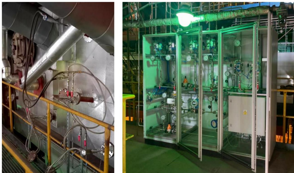
Obrázek 23 – Technologie SNCR pro čištění spalin biomasových kotlů [26].
