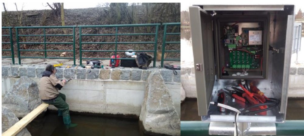
Obrázek č. 22: Instalace sledovacího zařízení
