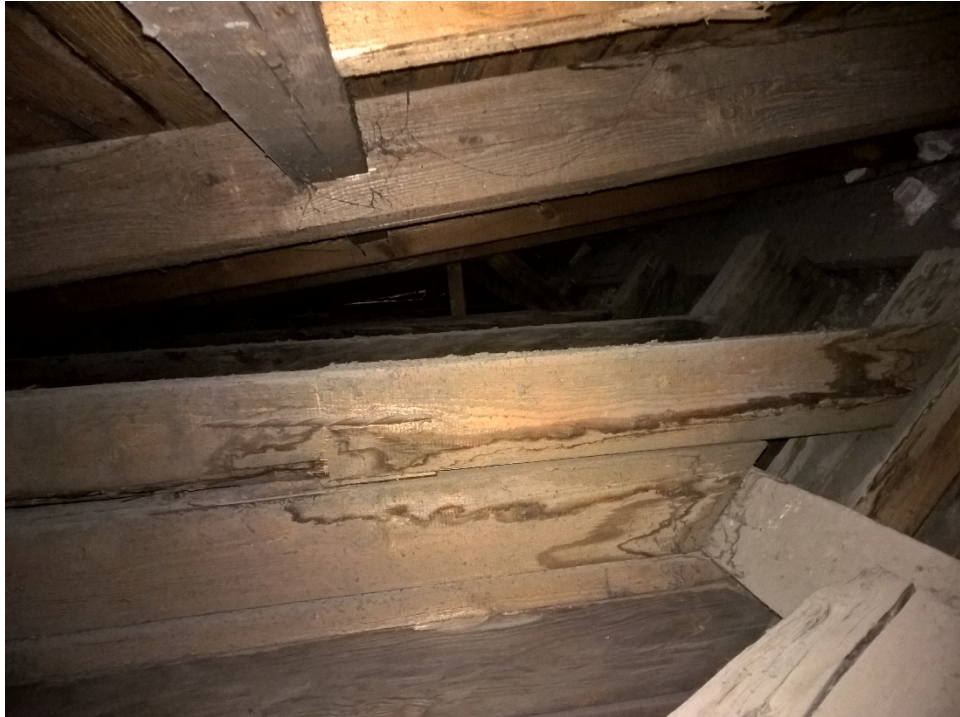
Obr. III: Stopy po zatečení poškozeným střešním pláštěm
