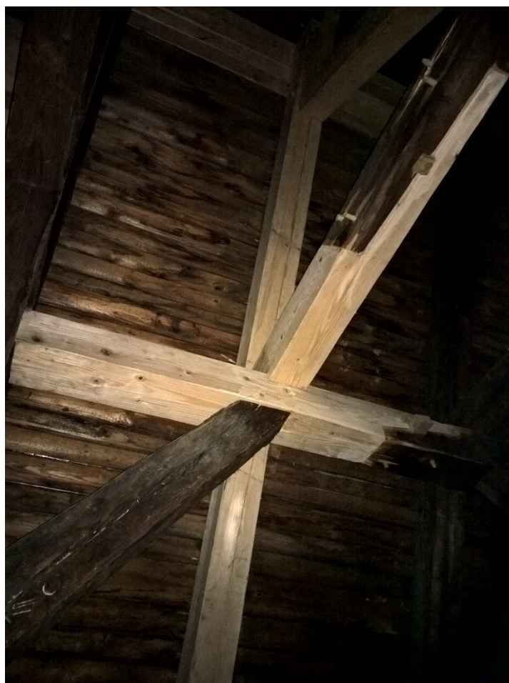
Obr. II: Nově nahrazené prvky krokve, vaznice a vzpěry v prázdné vazbě
