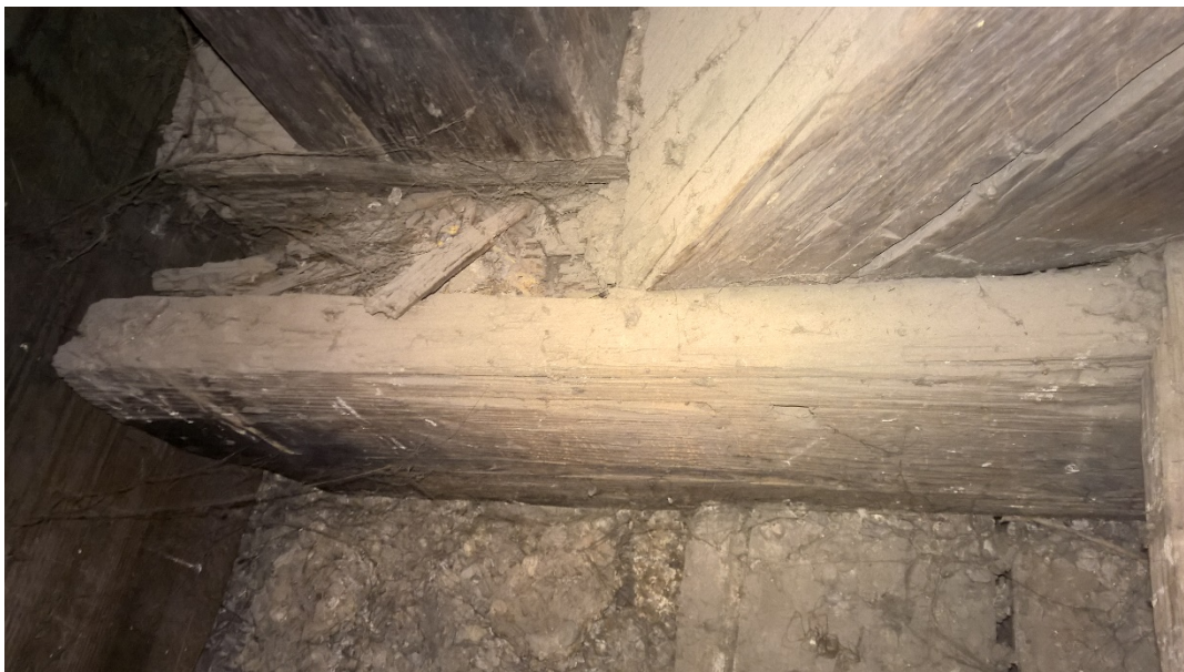
Obr. V: Zhlaví vazného trámu napadeného hnilobou
