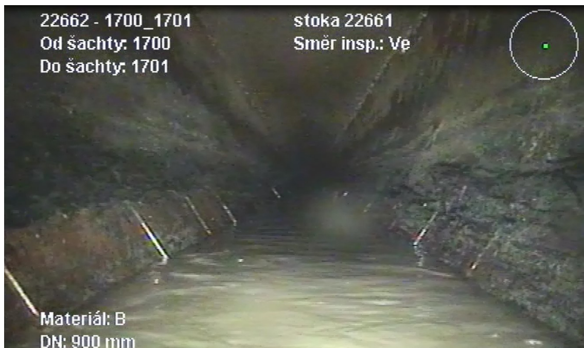
Obr. 6.2.1 15 Chybějící vložky na levé straně potrubí [V. Bajza]
