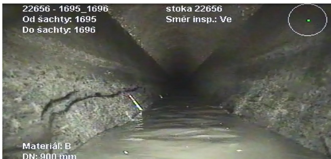
Obr. 6.2.1 5 Podélné praskliny [V. Bajza]
