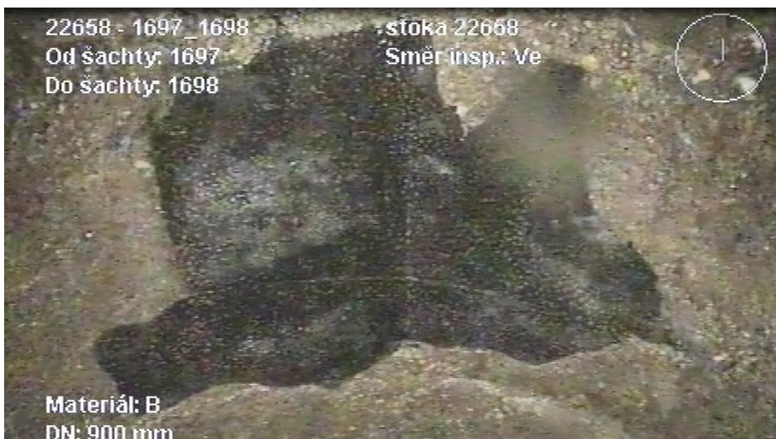
Obr. 6.2.18 Část zhroucené vrchní části potrubí [V. Bajza]
