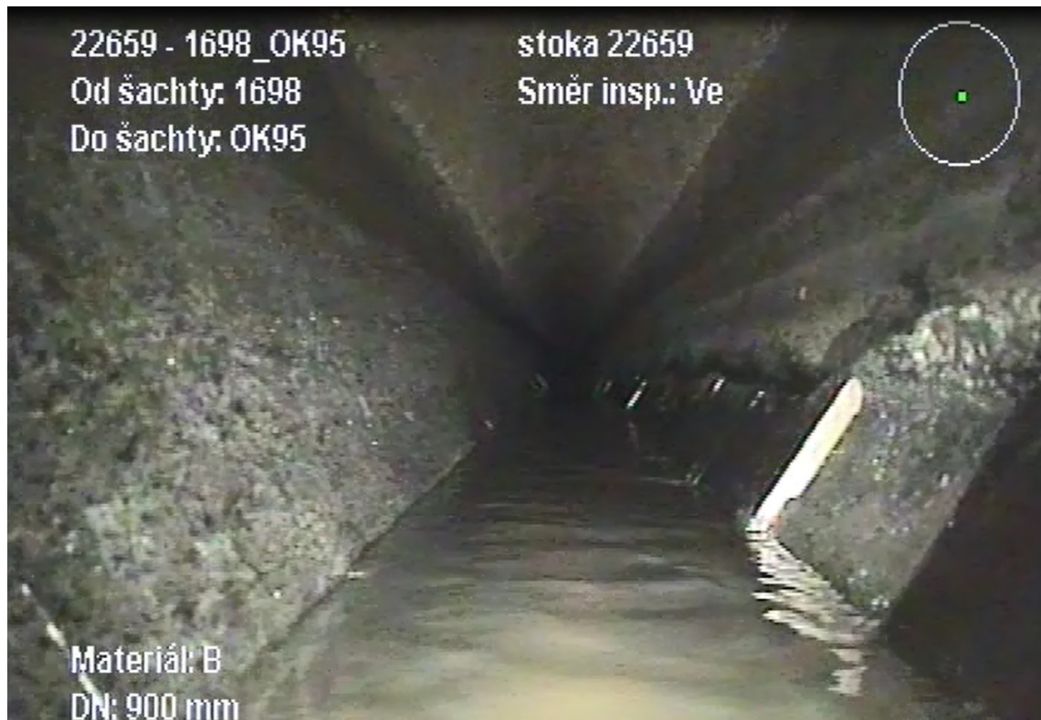
Obr. 6.2.1 11 Chybějící keramická vložka [V. Bajza]
