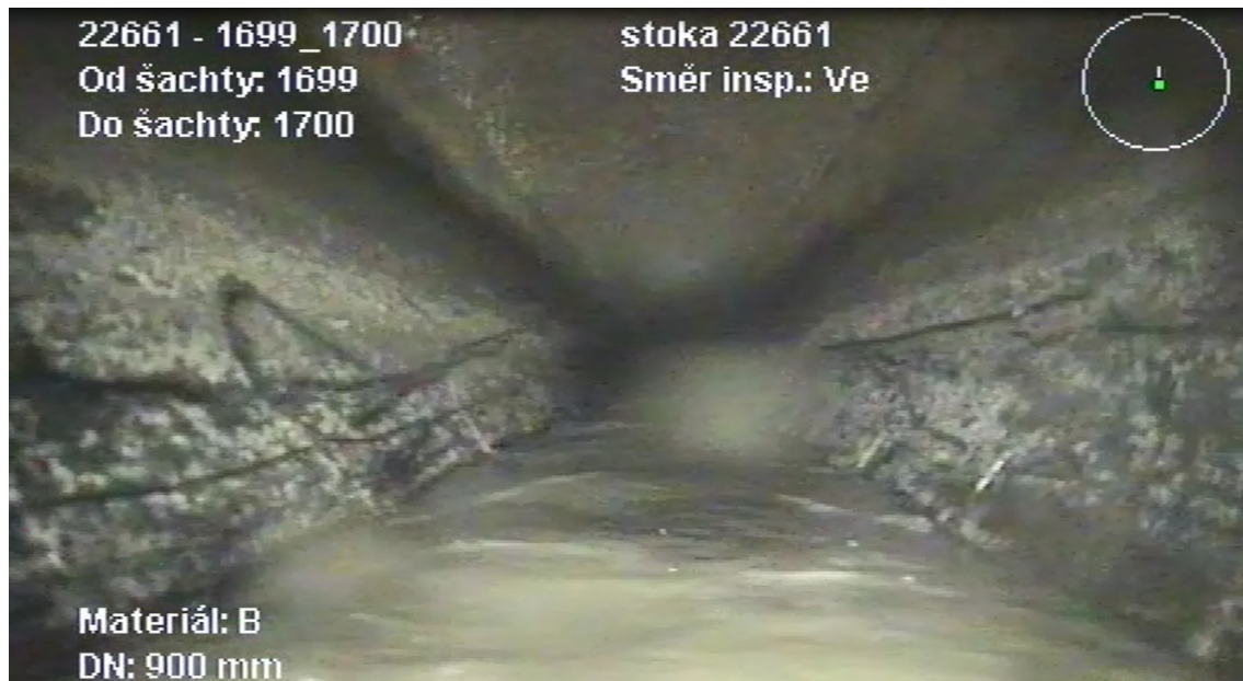
Obr. 6.2.1 14 Podélné praskliny na obou bocích profilu [V. Bajza]
