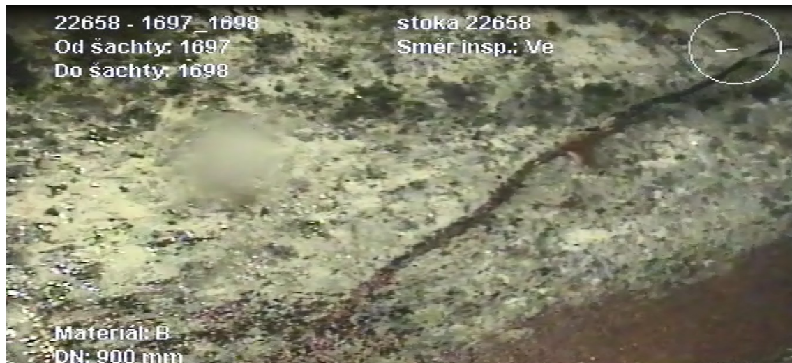
Obr. 6.2.1 9 Vznik podélných trhlin [V. Bajza]
