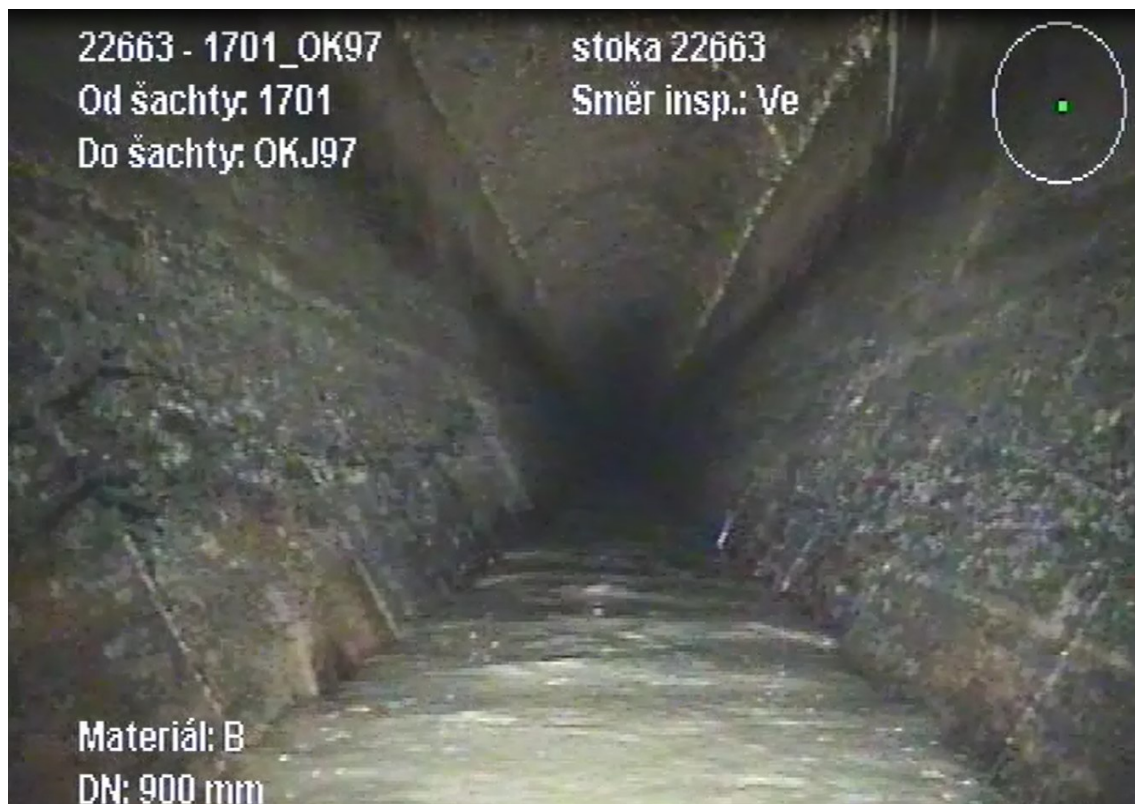
Obr. 6.2.1 19 Poškozený povrch a vznik trhlin [V. Bajza]
