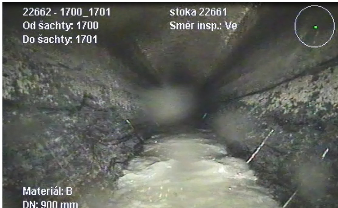
Obr. 6.2.116 Chybějící vložky a viditelná výztuž [V. Bajza]
