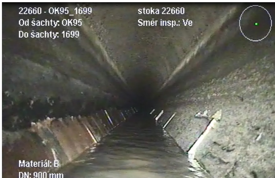
Obr. 6.2.113 Chybějící keramické vložky [V. Bajza]
