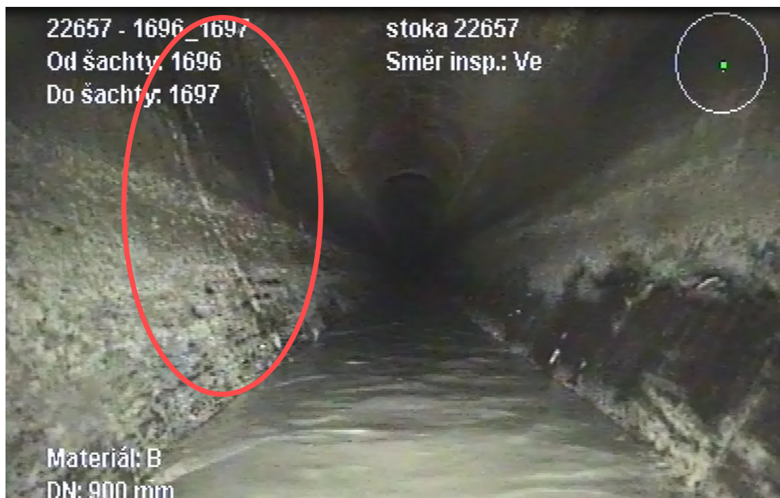
Obr. 6.2.1 6 Infiltrace vody na levé stěně potrubí [V. Bajza]
