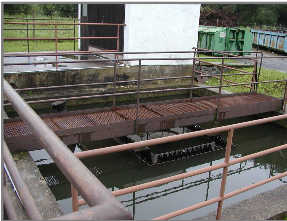
Obr.5 Čtvercová dosazovací nádrž v ČOV Jimramov
