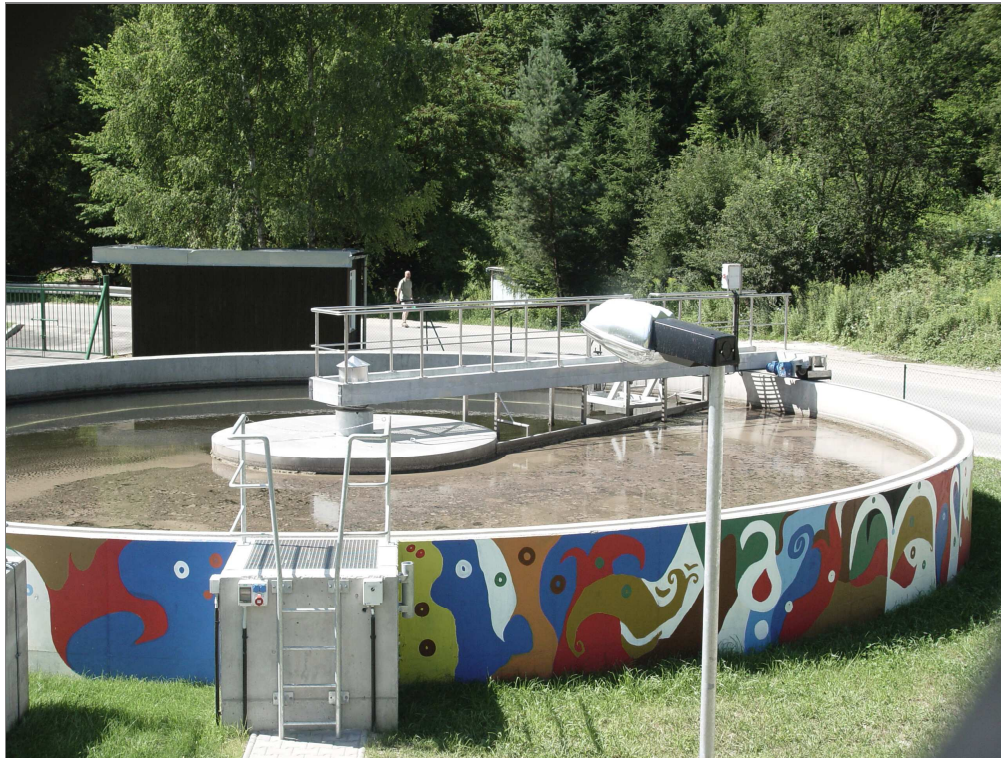
Obr.7 Systém stírání hladiny kruhové dosazovací nádrže v ČOV Adamov
