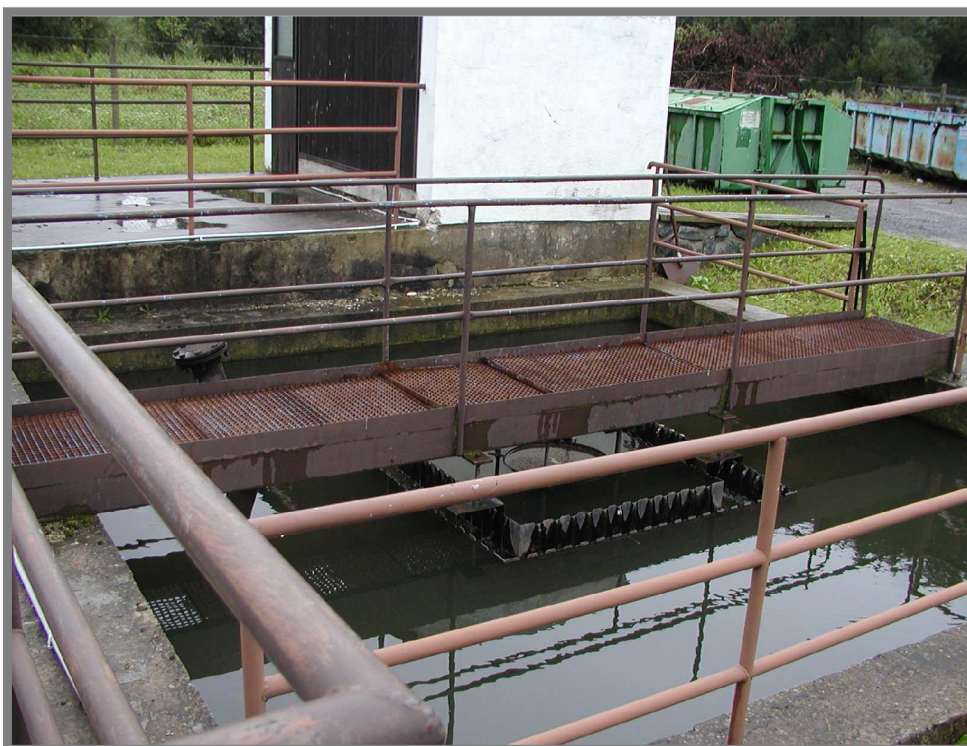
Obr.5 Čtvercová dosazovací nádrž v ČOV Jimramov
