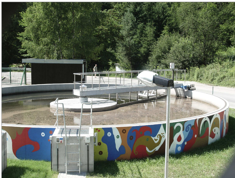
Obr.7 Systém stírání hladiny kruhové dosazovací nádrže v ČOV Adamov
