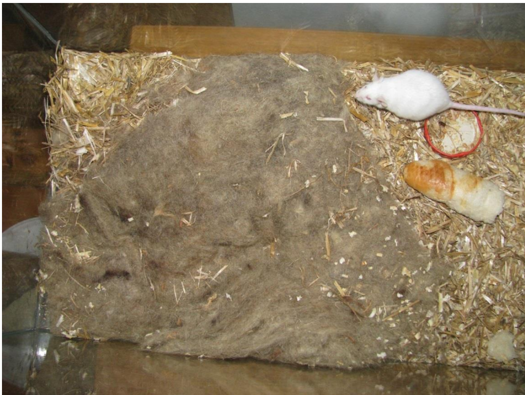
Obr 12. Hlodavcem porušená izolace po 14 dnech (Zdroj: vlastní foto)
