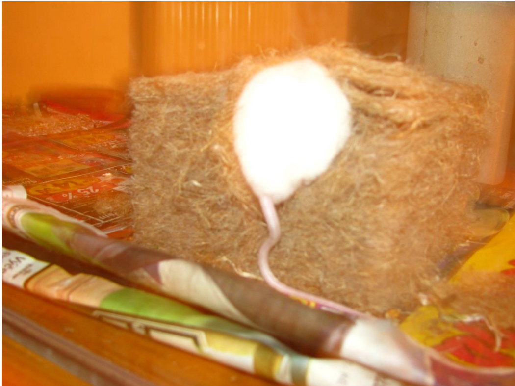
Obr. 2 Konopná izolace aktivně narušována hlodavcem (Zdroj: vlastní foto)
